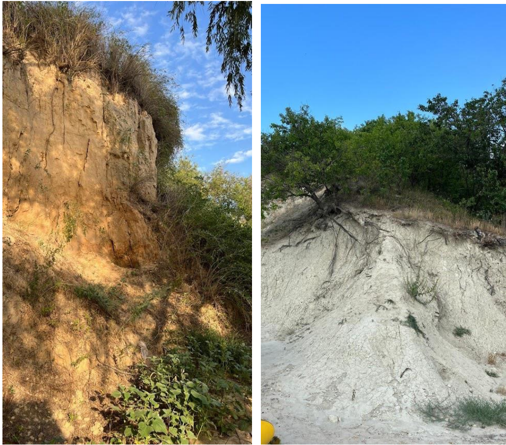
Рис. 4.1.4. Руйнування берегів Кременчуцького водосховища
