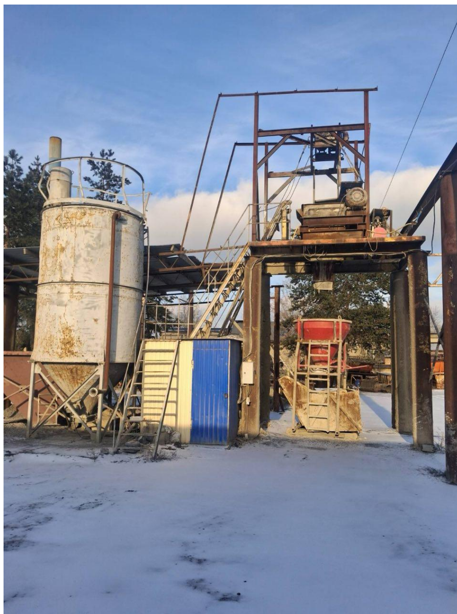
Рис. 4.5. Фото бетонозмішувальної установки: живильники однобункерні. Відсутність пневматичних затворів є принциповою відмінністю від прототипів
