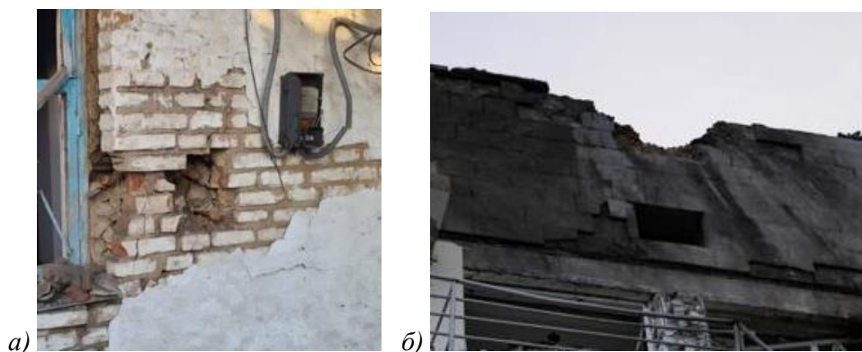
Рис. 3. Пошкодження кутових частин цегляних стін будівлі
