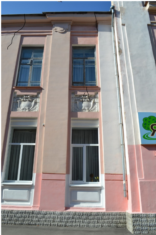
Тріщини шириною до 1 мм
