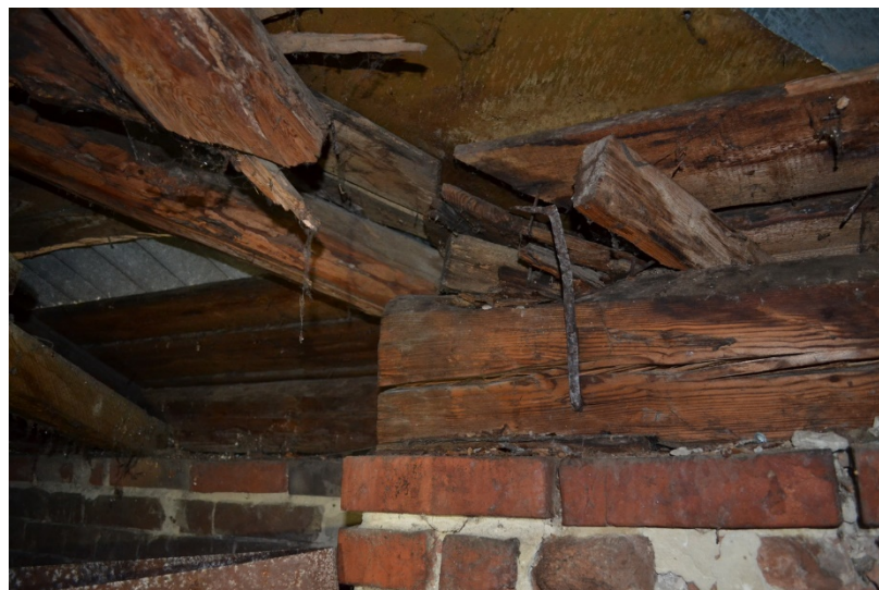
Відсутній несучий елемент кроквяної системи
