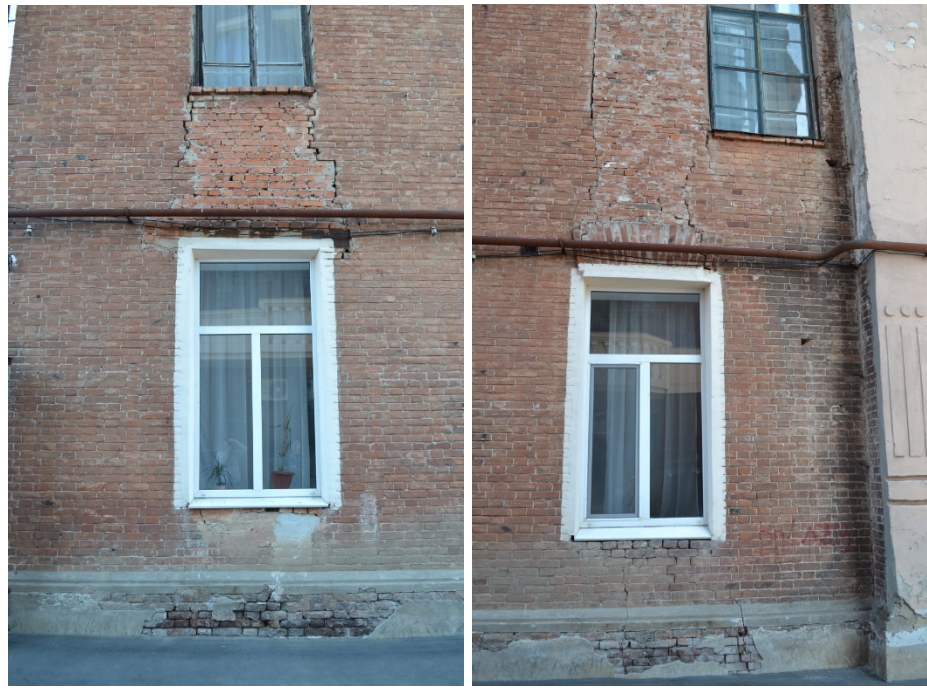
Замокання та руйнування оздоблювального шару
