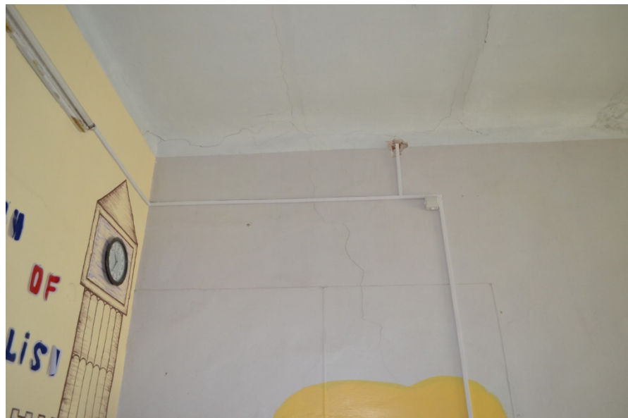
Тріщини по стелі та стінах шириною до 2 мм
