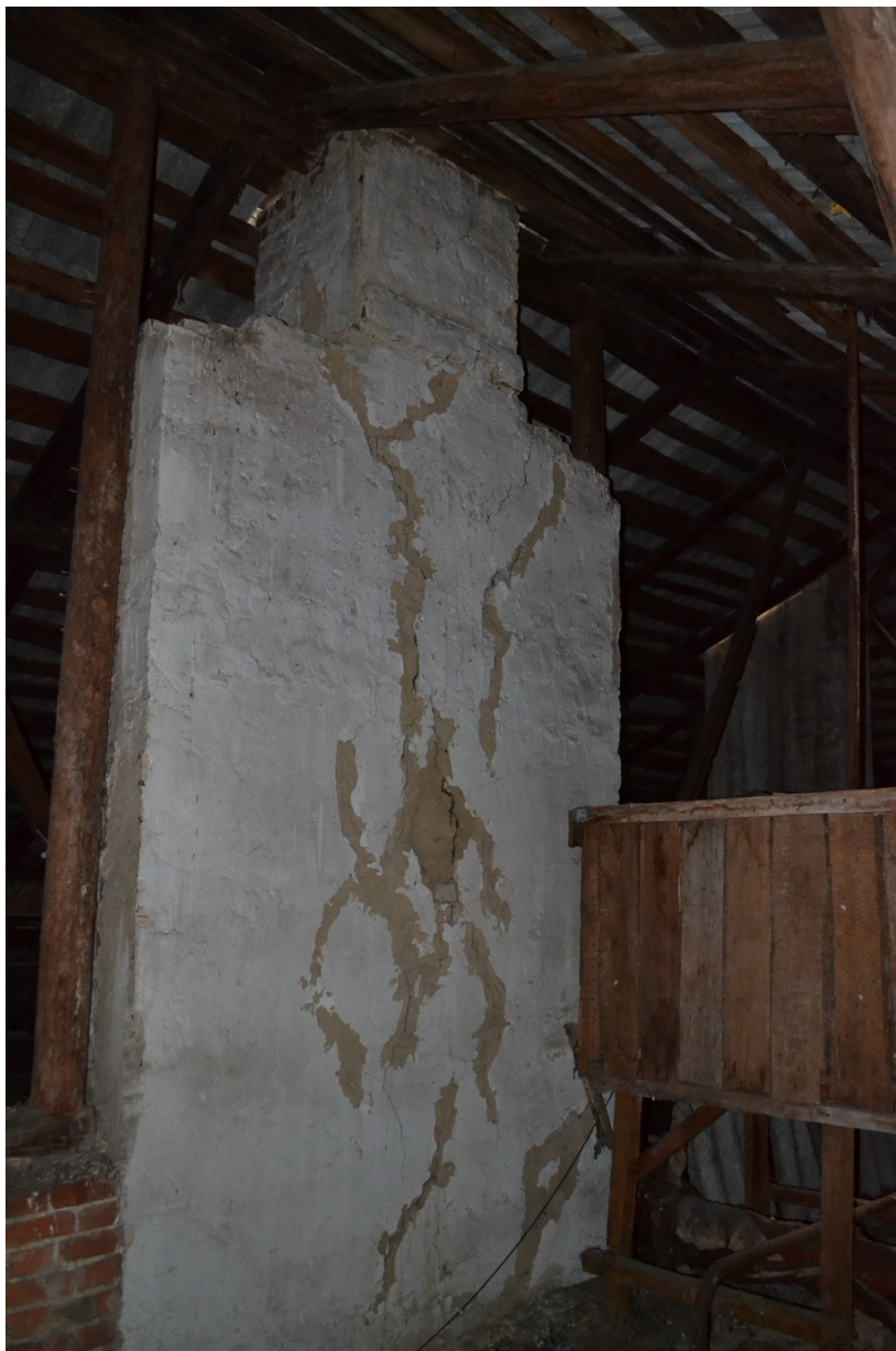
Руйнування вентиляційних каналів
