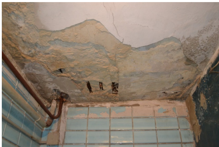
Корозійне пошкодження сталевих балок перекриття, руйнування оздоблювального шару
