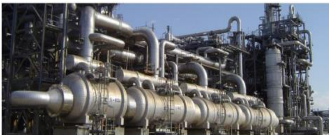
Рисунок 2.2 – Теплообмінники пропанового котла на заводах LNG [62]
