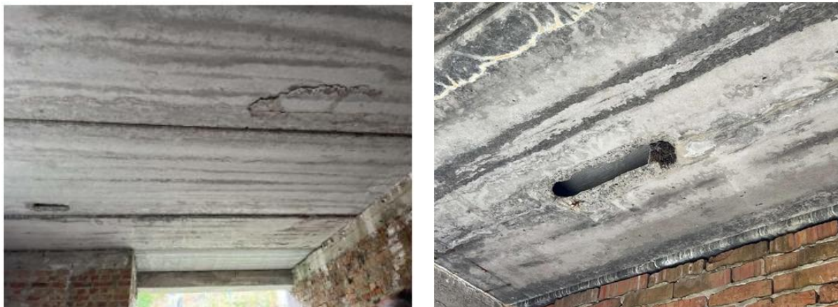
Рис. 3.6 – Морозобійне руйнування порожнин залізобетонної плити в осях А-Г, 3-4
