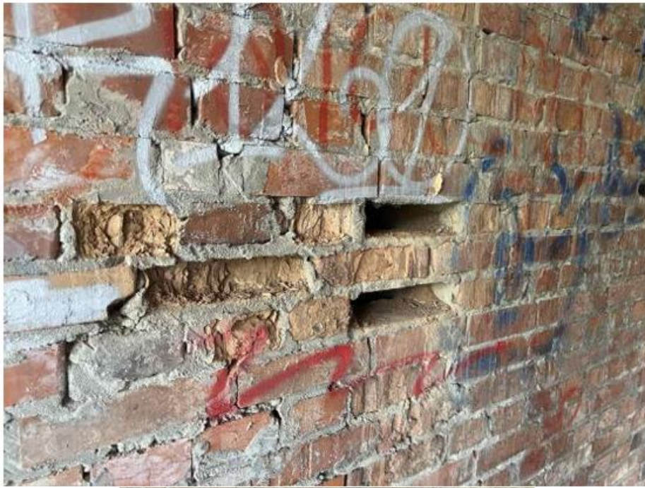
Рис. 3.4 – Фото дефекту 2 поверх, приміщення №31, вісь Ж, 1-3
