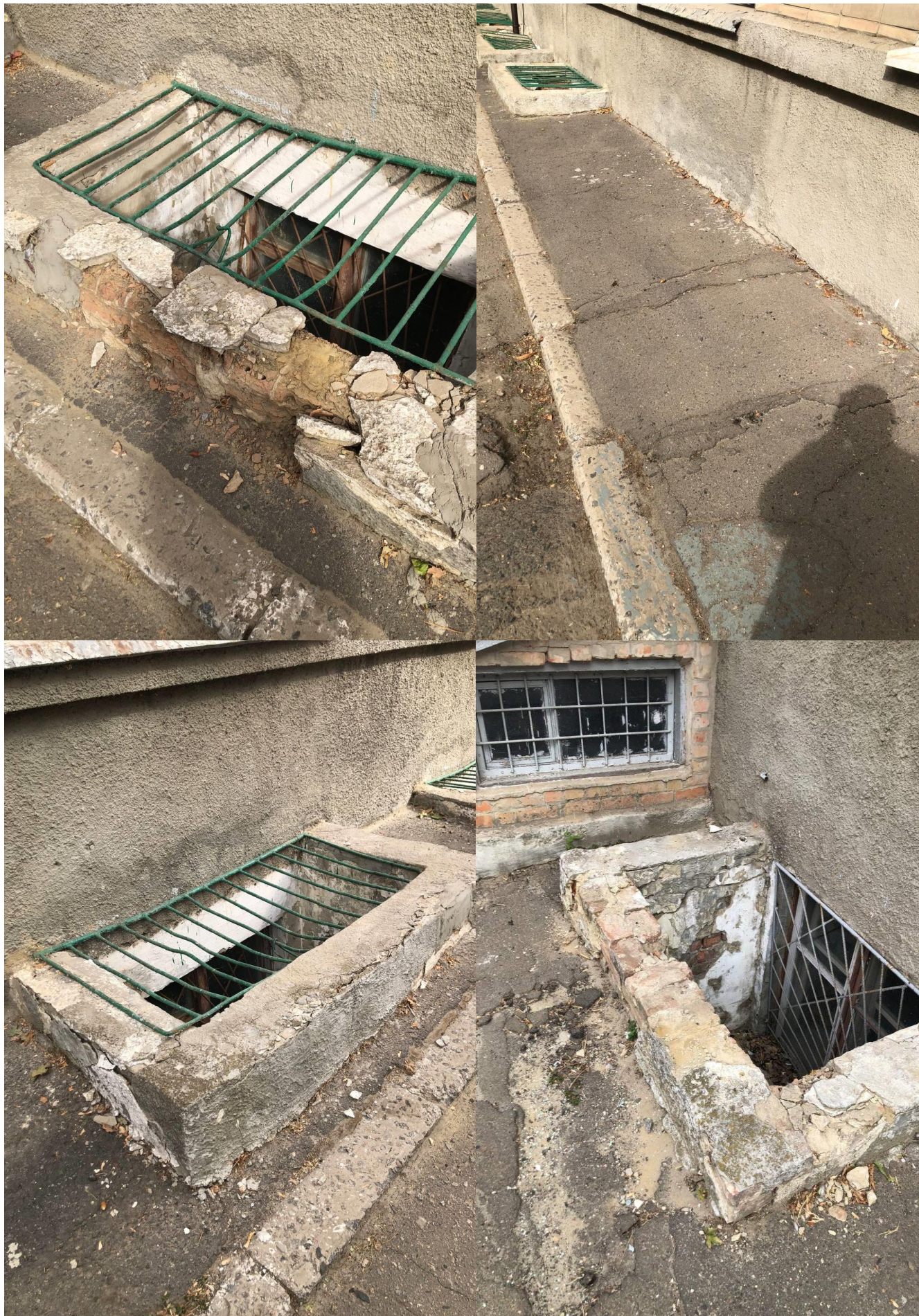
Рис. 2.5. Фото перелік пошкодження зовнішньої відмостки з приямками
