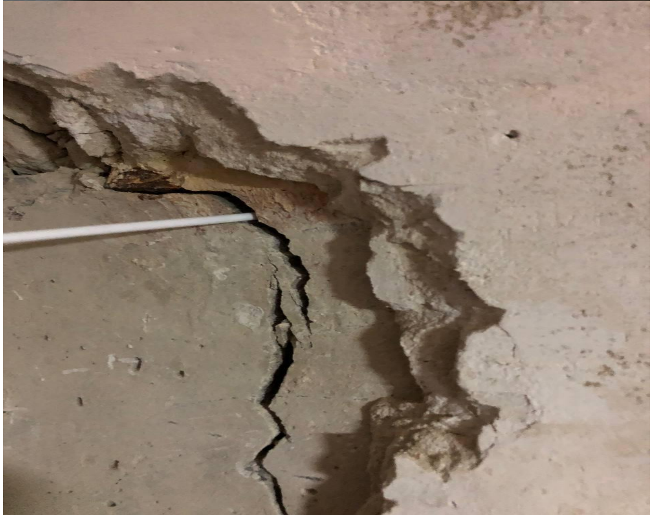
Рис. 2.6. Фото перелік пошкодження конструкцій.
