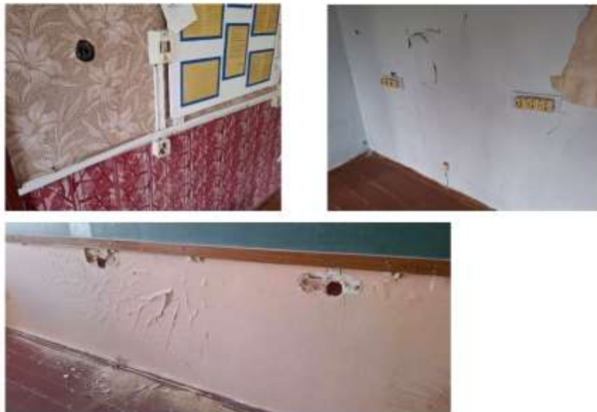
Рисунок 1.13 Стан електропроводки та електрофурнітури
