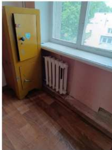
Рисунок 1.8. Пошкоджений опалювальний прилад
