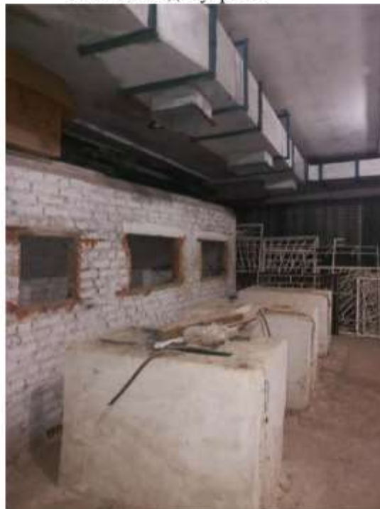
Мал. 3. Приміщення вентиляційної
