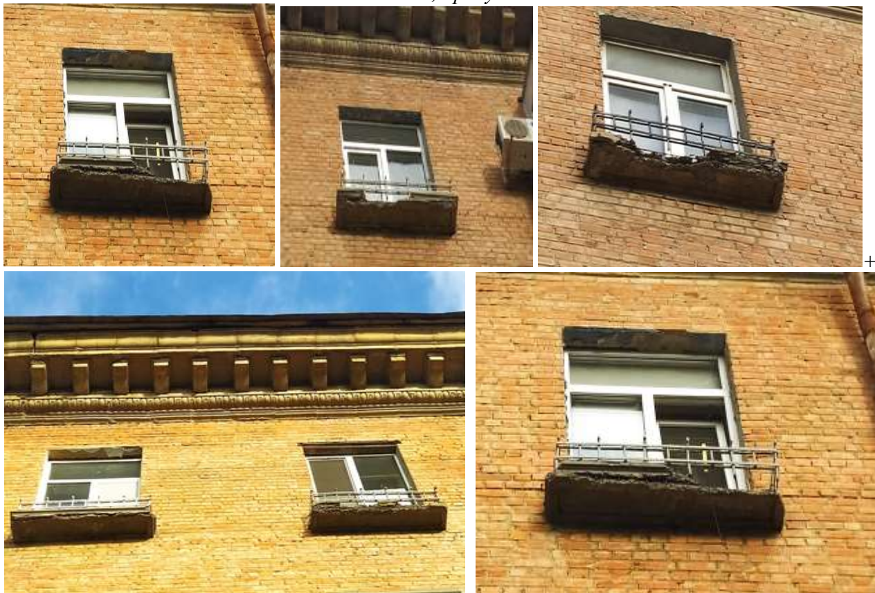
Рис.3.20. – Виступаюче фасадне підвіконня, м. Полтава, вулиця Соборності, 44
