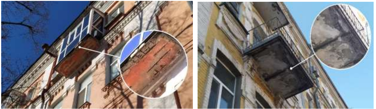
Рис. 3.13. – м. Полтава, вулиця Соборності, балкони в аварійному стані
