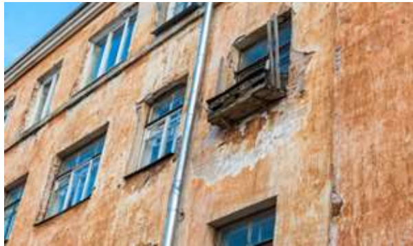
Рис.3.2.– Аварійний балкон на фасаді багатоквартирного будинку, Італія
