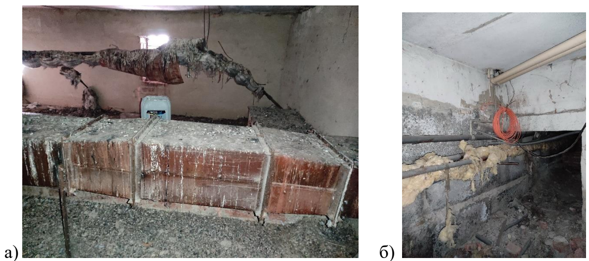
Рис. 1 Стан утеплення магістральних трубопроводів навчального корпусу «Ф» а) на горищі; б) в приміщеннях підвалу
