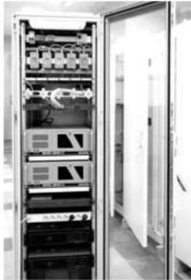
Рисунок 4.4 – Загальний вигляд шафи системи автоматизації вентиляторної градирні
