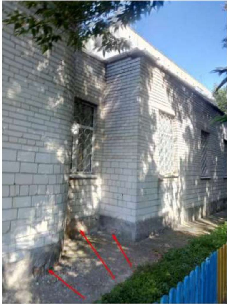
Рисунок 2.6 – Відокремлення захисного шару цоколю, тріщини в цегляній кладці та її руйнування по осі Г
