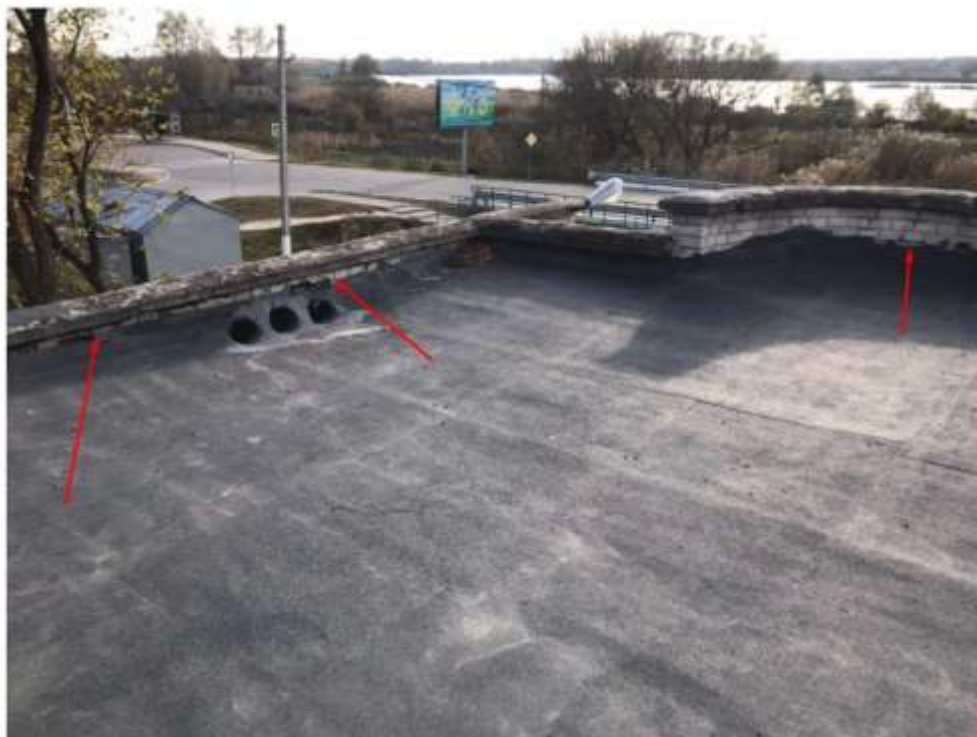
Рисунок 2.11 – Нещільне примикання покрівлі до парапету
