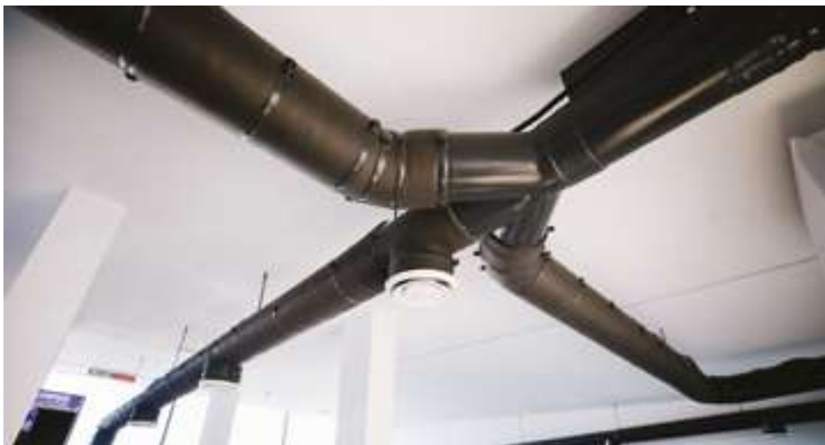
Рисунок 1.3 – Система вентиляції повітря у ЦНАП в Полонській ТГ
