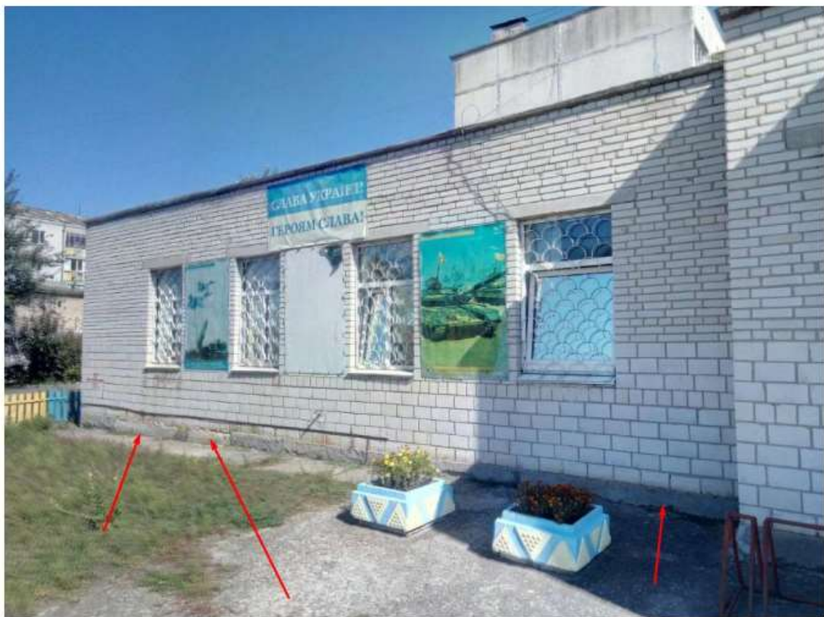
Рисунок 2.5 – Відокремлення захисного шару цоколю по осі 4
