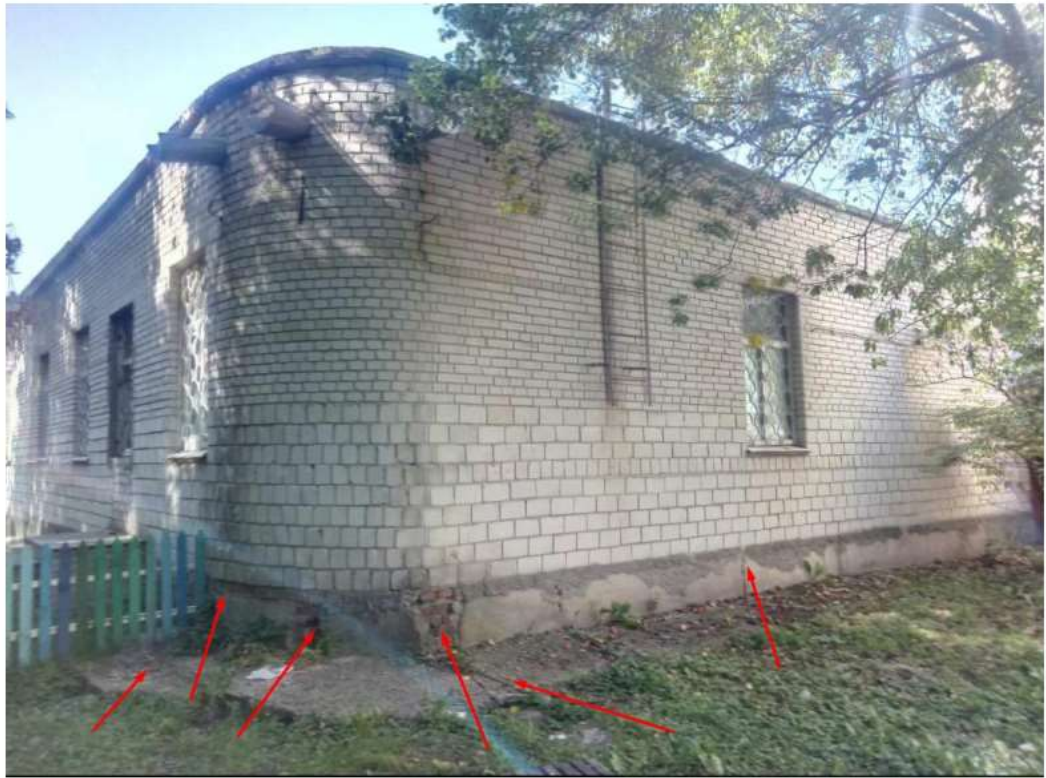
Рисунок 2.7 – Відокремлення захисного шару цоколю, тріщини в цегляній кладці та її руйнування, тріщини у вимощенні по осі 1
