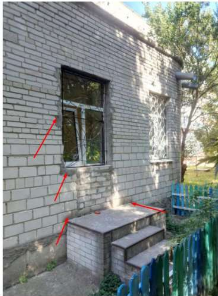
Рисунок 2.13 – Сліди замочування кладки стіни з відокремленням плитки та випадінням розчину із швів по осі Г
