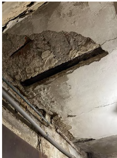
Фото 2. Відшарування захисного шару бетону
