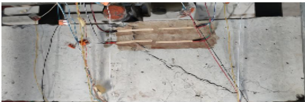
Рисунок 4 – Фрагмент ділянки балки Б-300-150 у місці руйнування
