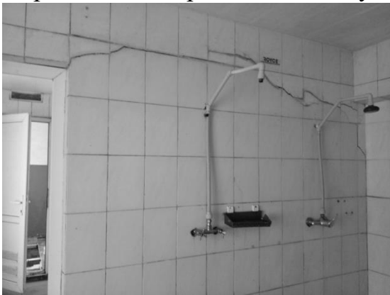
а) – горизонтальні тріщини в душовій
