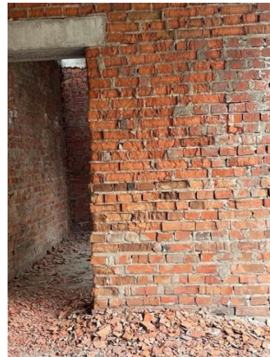
Рис. 2 Морозобійне пошкодження цегляної кладки
