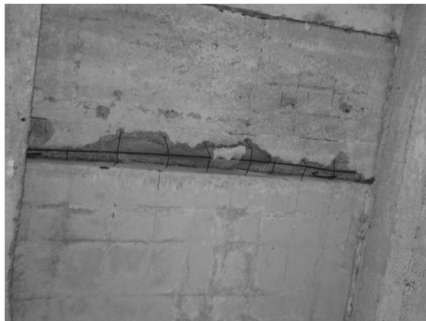
Рис. 1. Часткове руйнування бетону плити перекриття в розтягнутій зоні та корозія арматури
