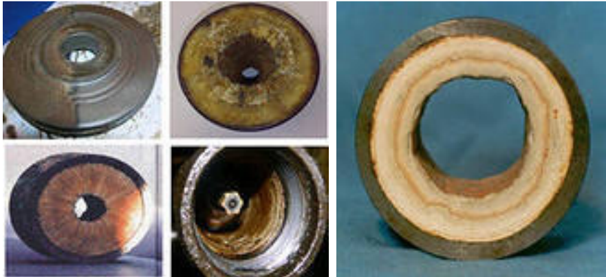
Рис.1 Приклади утворення солей на насосно-компресорних трубах
