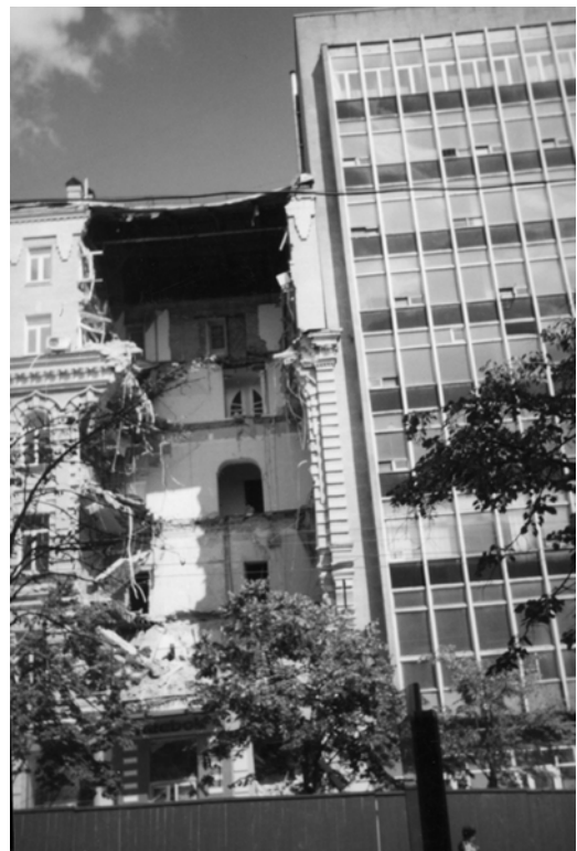
Рисунок 5 – Аварійне руйнування несучої цегляної стіни під час виконання робіт з реконструкції будівлі
