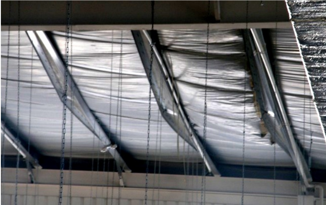
Рис. 1. Аварійний стан покриття гіпермаркету «Епіцентр К» в м. Миколаїв
