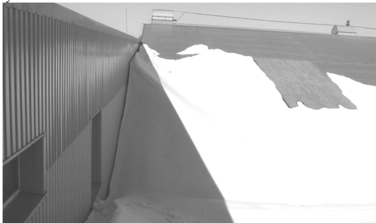
Рисунок 2. «Сніговий мішок» на покрівлі промислової будівлі, 2013 р.
