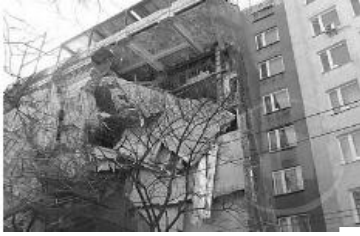
Фото 1. Обвалення будівлі в м. Харків, Україна
