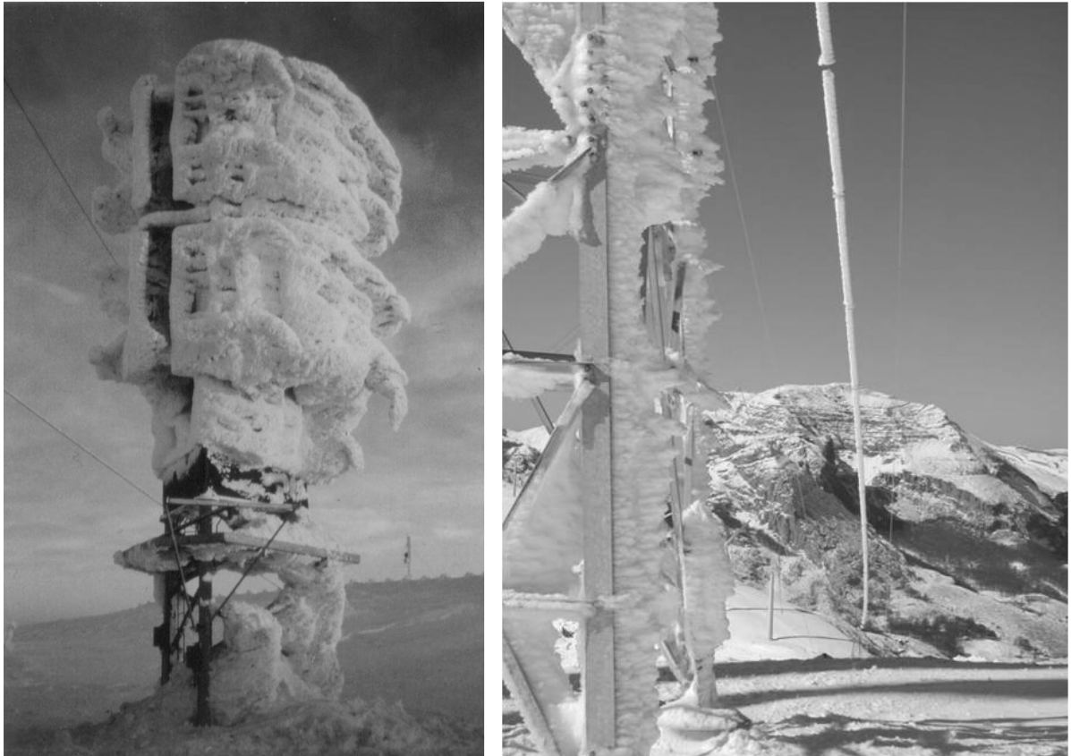
Рисунок 1 – Характерні ожеледні відкладення на будівельних конструкціях
