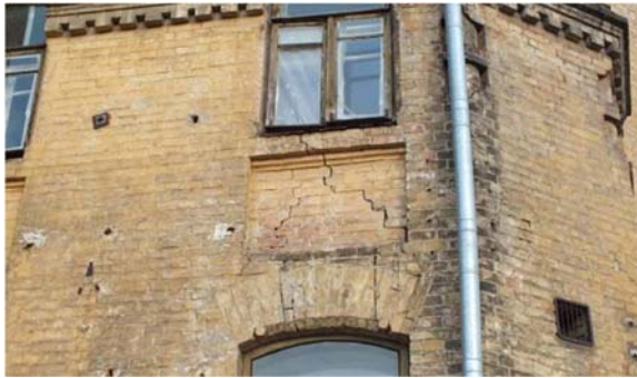
Рис.6. Характерні пошкодження у конструкціях будівель, що потрапили в зону впливу зведення ТРЦ
