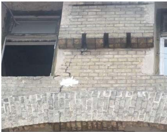
Рис. 10. Фото тріщини у будівлі ДМС поблизу деформаційної марки №11
