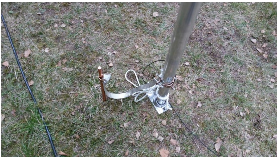
Мал. 8.12. Обладнання заземлення щогли антени КХ
