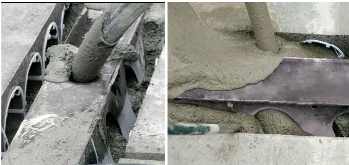
Рисунок 1.3 – Заповнення внутрішніх порожнин ригеля та приопорних ділянок збірних залізобетонних плит бетонною сумішшю
