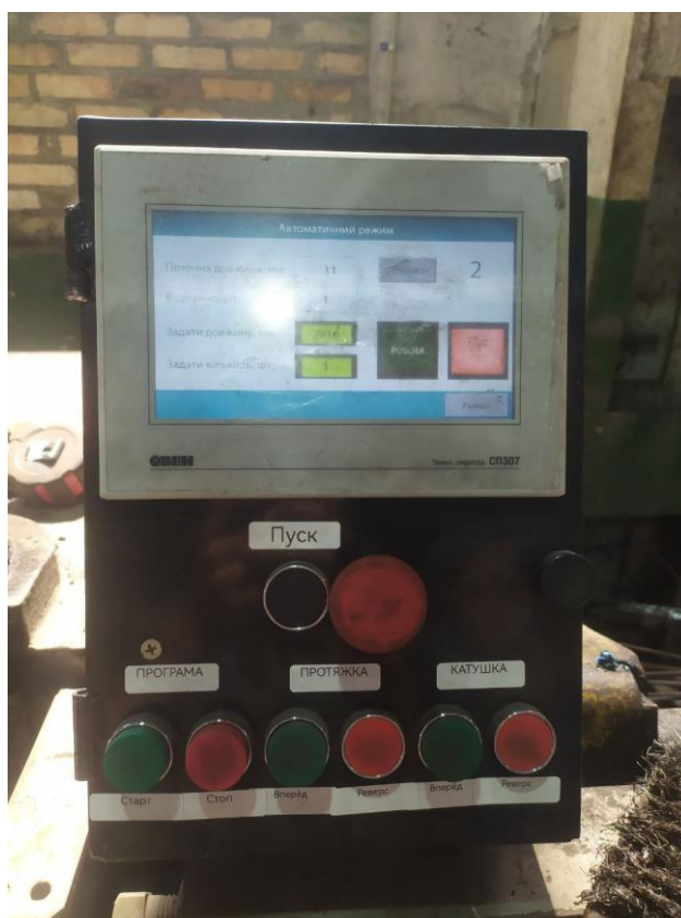
Рисунок 3.5 – Встановлена панель оператора СП 307Р, AQTECK
