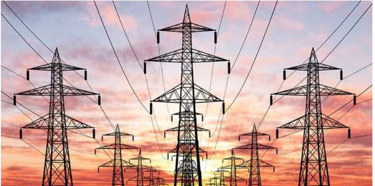
Рисунок 1.5 – Повітряні лінії електропередач
