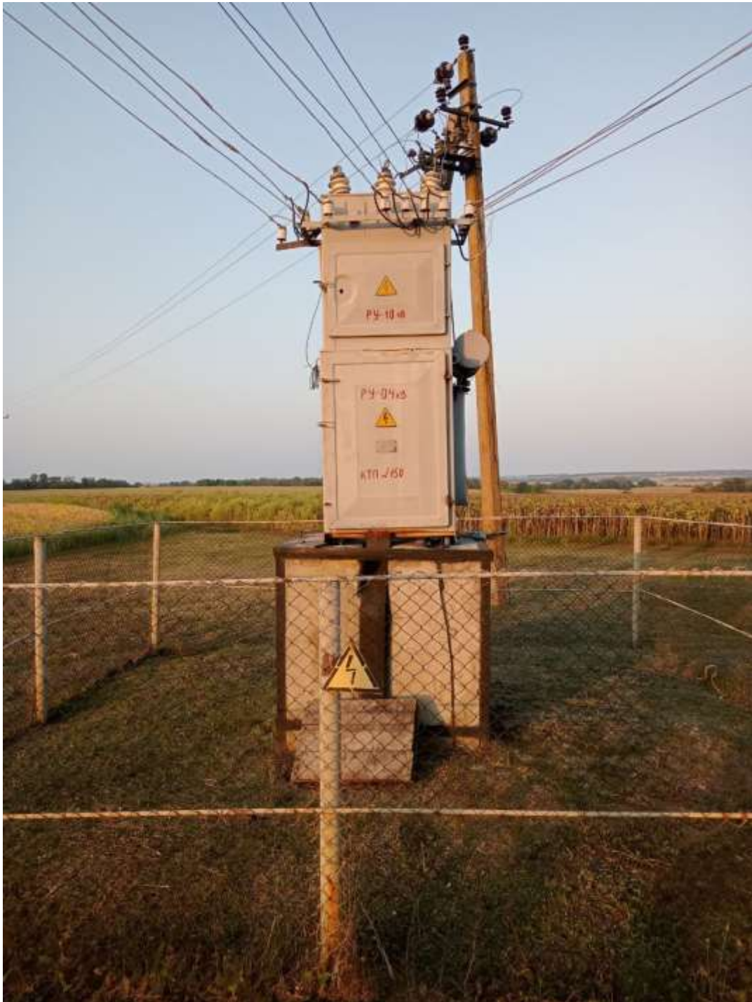
Рисунок 1.6 – Комплектна трансформаторна підстанція
