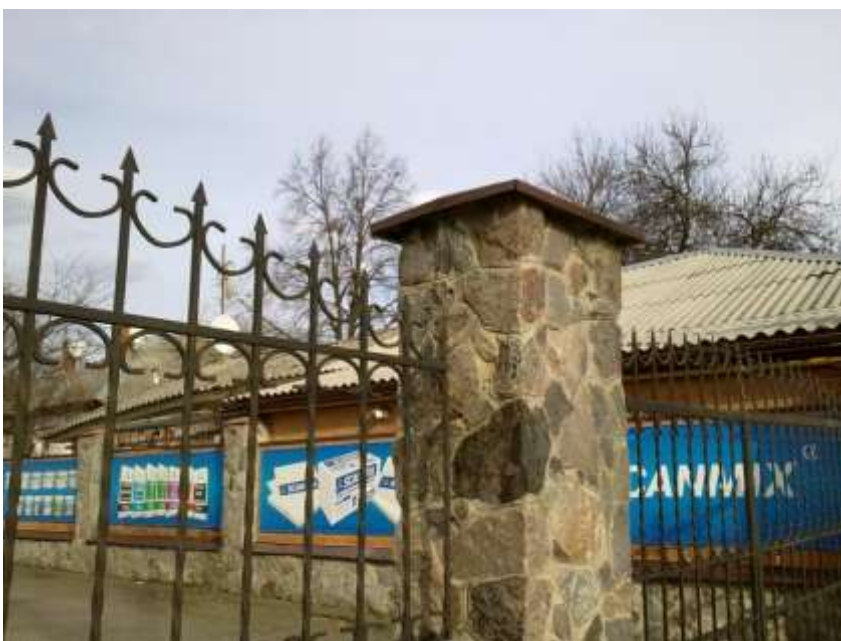
Рис. 2.4. Кришка з чорного металу для захисту верхньої частини кам'яної опори
