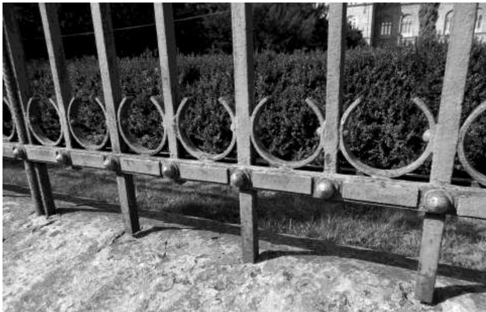
Рис. 4.55. З'єднання стійок огорожі із тягами за допомогою заклепок із застосуванням ковальської обробки металу
