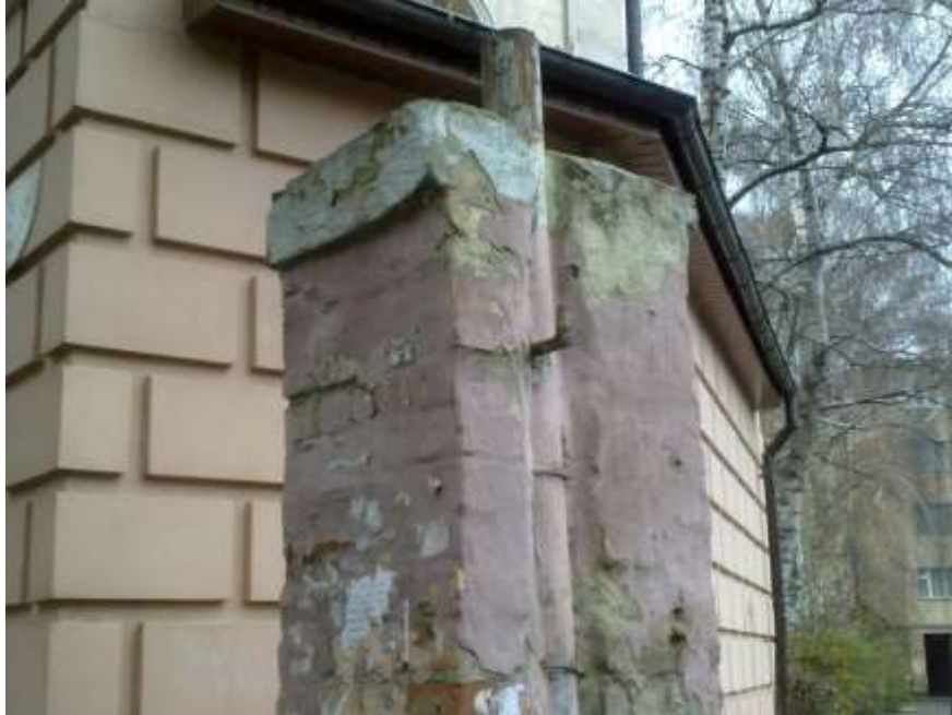
Рис. 3.10. Металева труба, закладена в цегляну опору для кріплення консолей зі стрижнями
