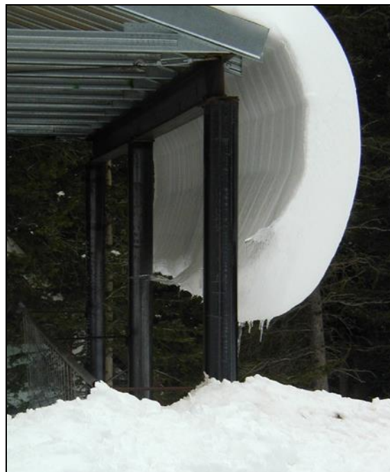
Рис. 10.12. Характерні приклади зависання снігу на карнизах покрівель
