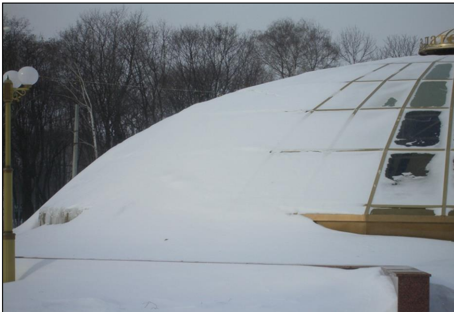
Рис. 10.9. Незбалансоване снігове навантаження на склепінчасте покриття (підземний перехід «Злато місто» в м. Полтава)
