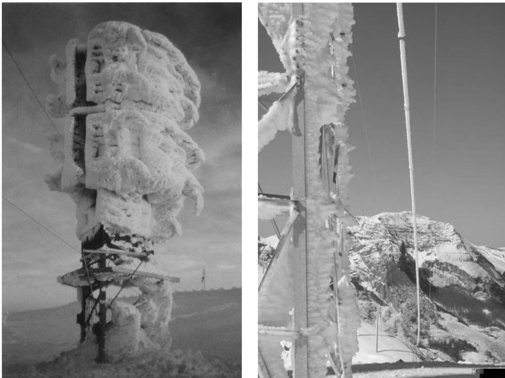
15.10. Характерні ожеледні відкладення на будівельних конструкціях
