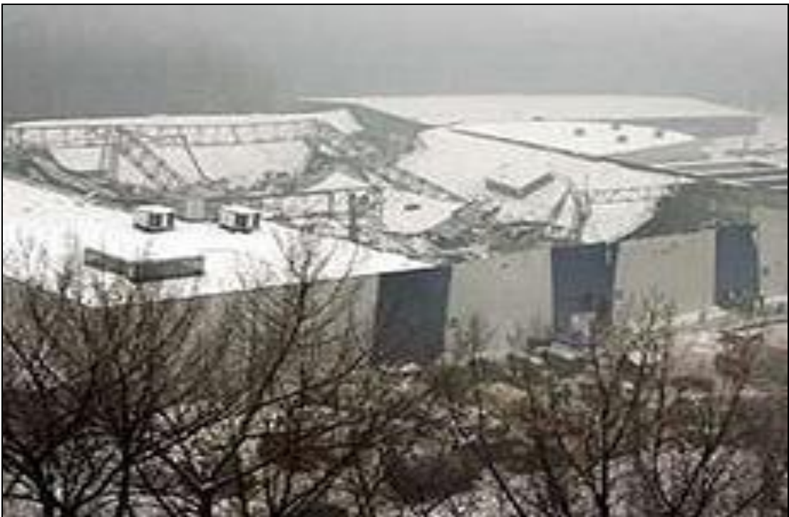
Рис. 9.4. Руйнування покриття торгівельно-виставкового павільйону (м. Катовіце, Польща)
