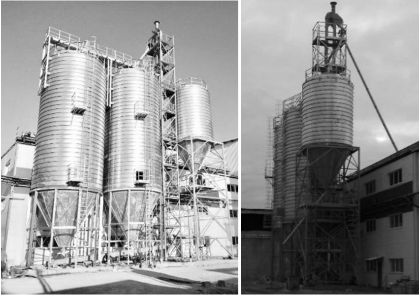
Рис. 5. Котельня, працююча на лущинні соняшника, м. Кривий Ріг
