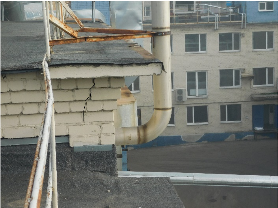
Рис. 3.3 Тріщини у несучих стінах по осі 3 та 5
