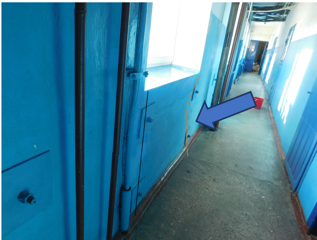
Рис. 3.5 Вигин несучої стіни по осі Д (3-4) у місці влаштування технологічної площадки
