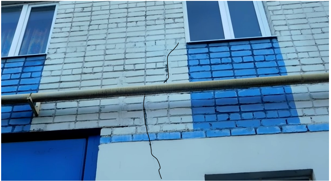
Рис. 3.1 Тріщини у несучих стінах по осі К
