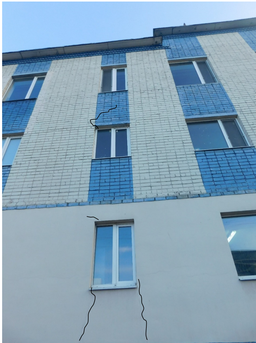
Рис. 3.2 Тріщини у несучих стінах по осі К
