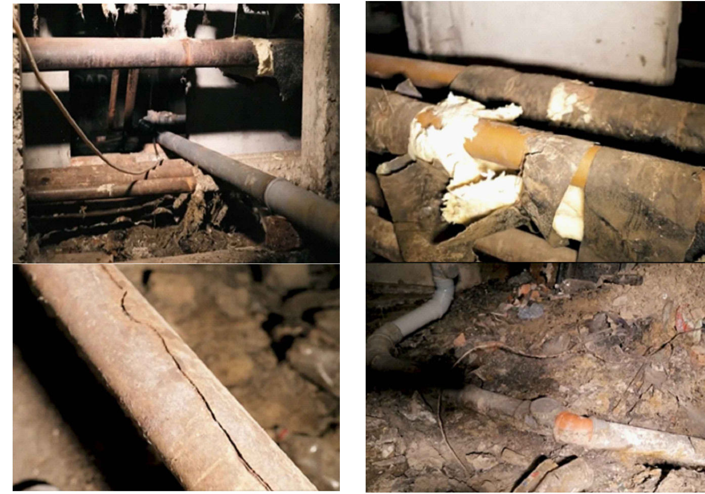
Підвальне приміщення(труби опалення)
