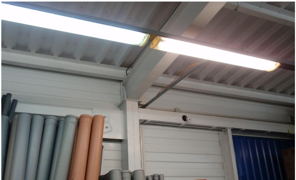
Рис. 1.12 – Відсутні опорні ребра в опорних вузлах головних балок каркасу будівлі А
