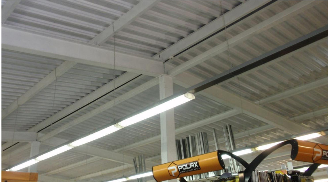
Рис. 1.11 – Відсутність жорстких вузлів або в'язей в поперечних рамах будівлі А
