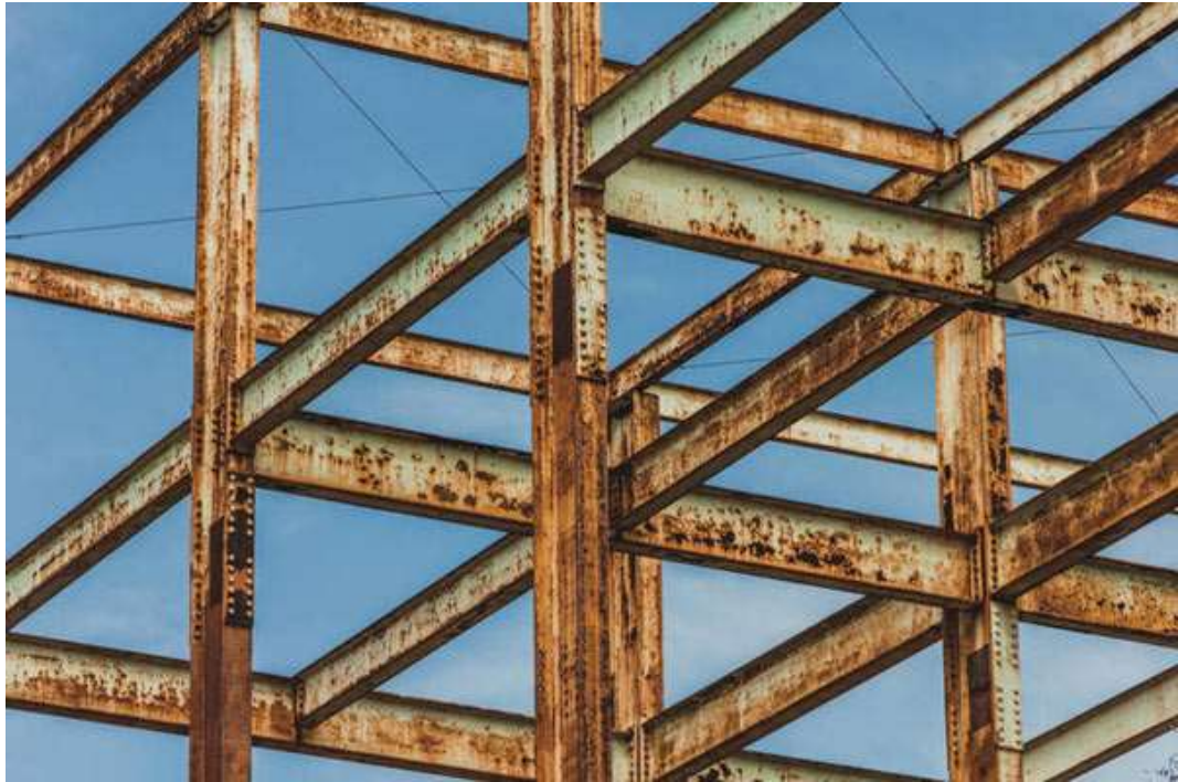
Рисунок 1.8 – Наслідок відсутності захисного шару фарби, корозія металу
