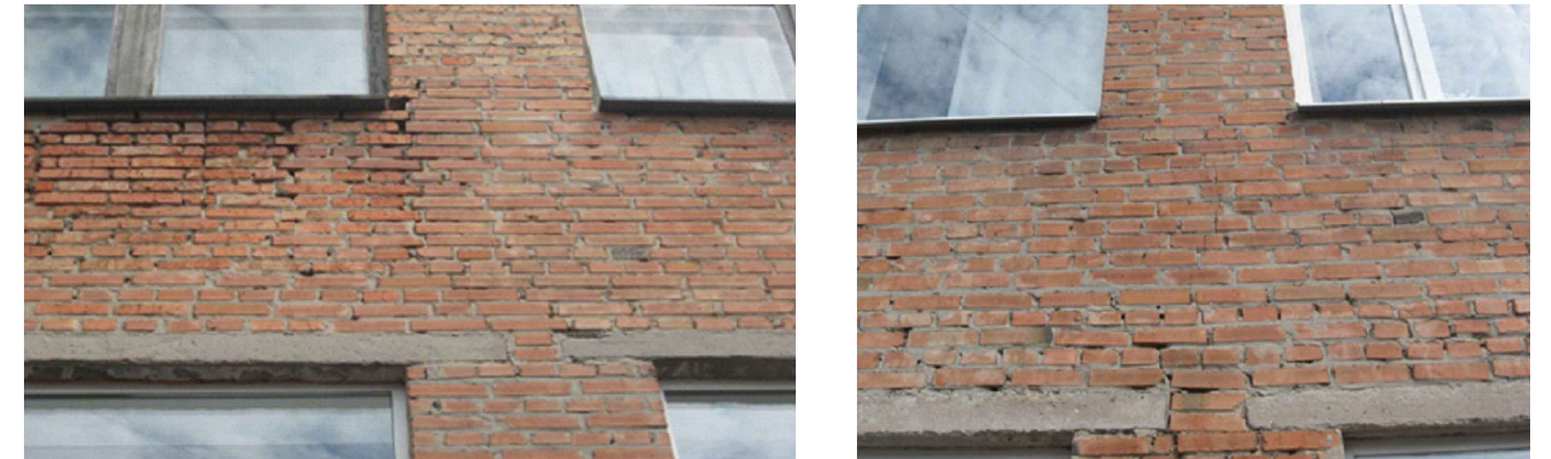
Тріщини в цегляних стінах шириною розкриття від 2 до 10 мм
