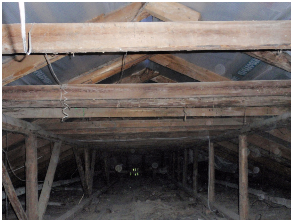
Рис. 2.10 – Загальний вигляд дерев'яної кроквяної системи учбового корпусу Полтавського обласного центру науково-технічної творчості учнівської молоді ПОР
