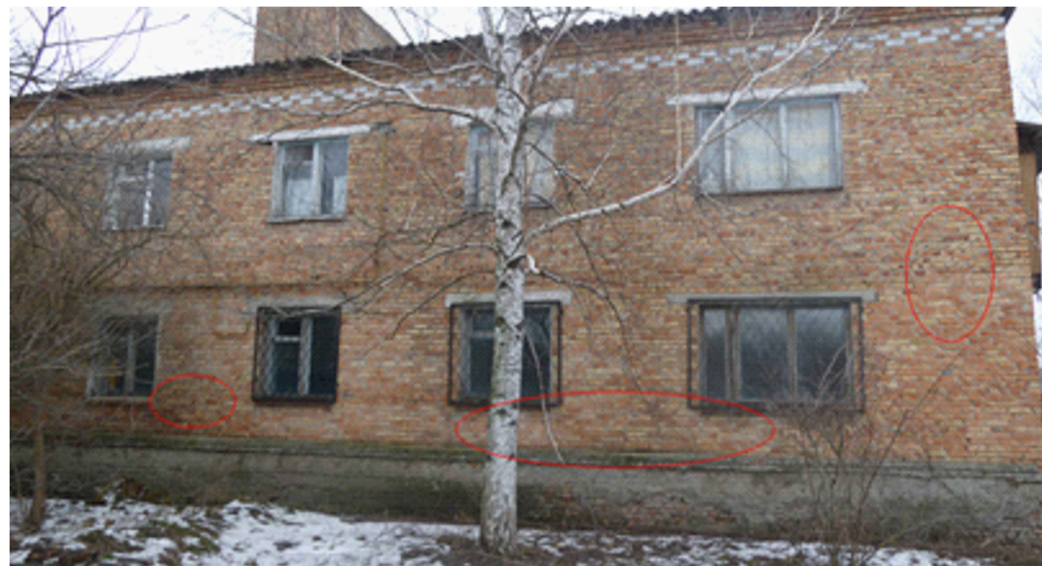
Ерозія, морозобійне руйнування цегляної та випадання швів між цеглою фасаду в осях 4-1
