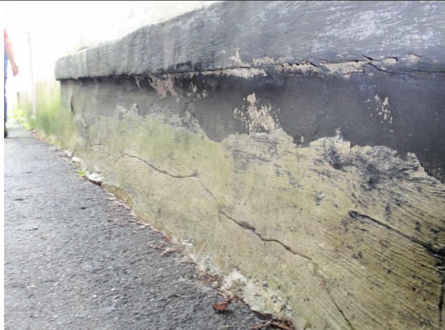
Тріщина у цоколі, ширина розкриття 2 мм
