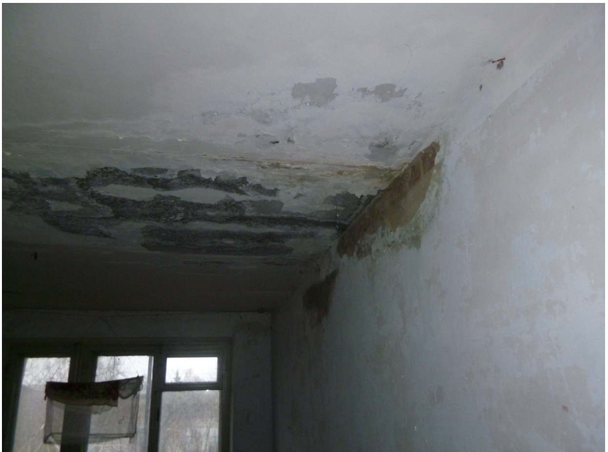
Рис. 3.4 – Сліди замокання на поверхні стелі та стін зсередини приміщень будівлі ФАП
