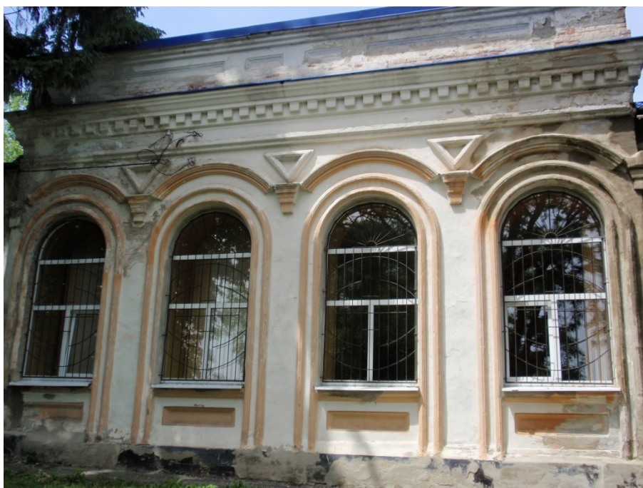
Рис. 2.6 – Загальний вигляд фасаду учбового корпусу Полтавського обласного центру науково-технічної творчості учнівської молоді ПОР в осях 8-12
