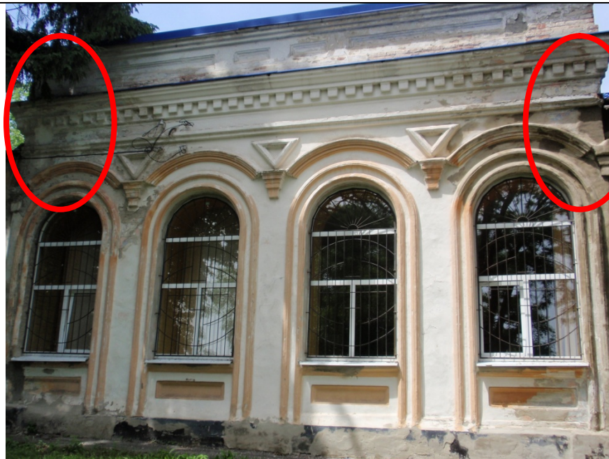
Замокання несучих огорожувальних конструкцій
