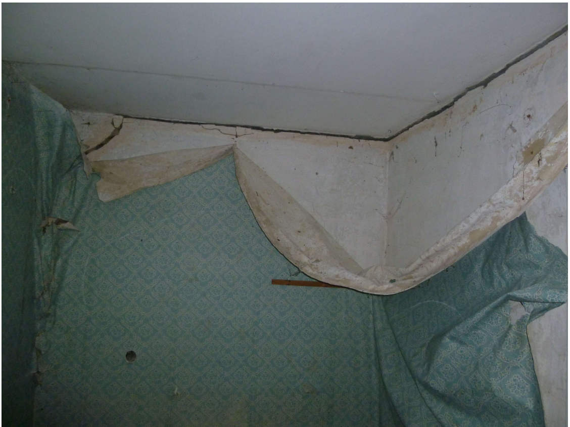
Рис. 3.6 – Відшарування перегородок від стелі у житлових приміщеннях
