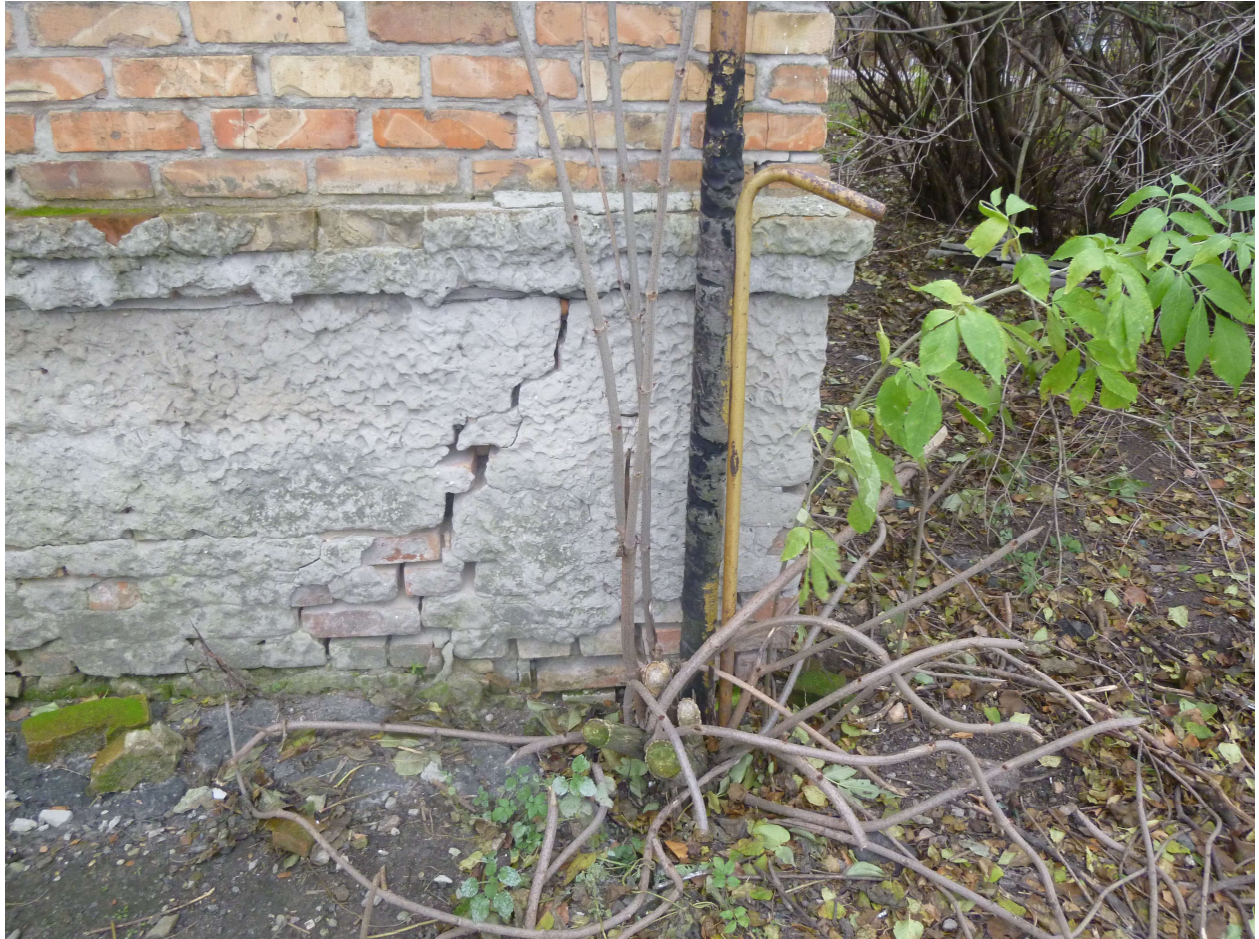
Рис. 2.19 – Наявність зелених насаджень на відстані менше 3 м від будівлі
