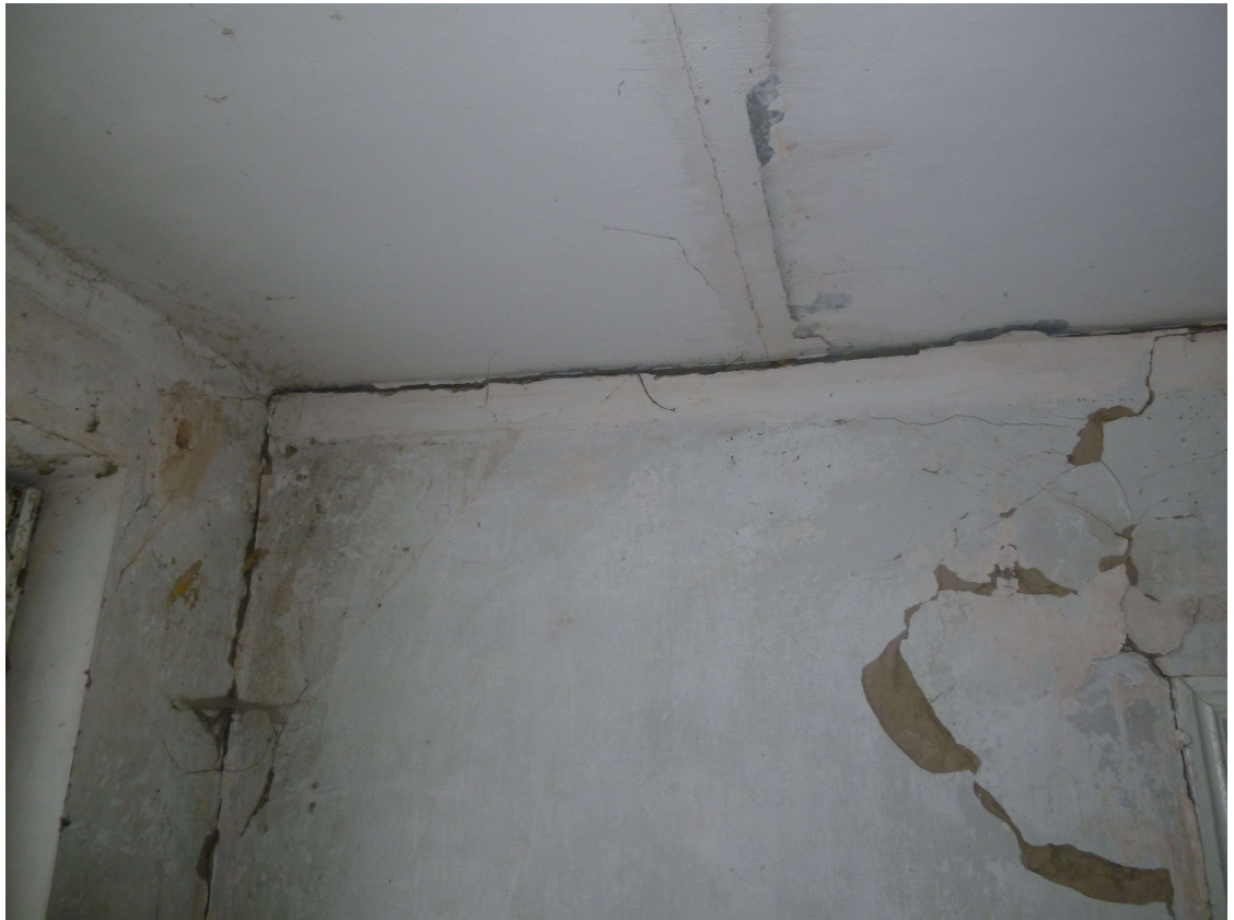
Рис. 3.5 – Руйнування захисного шару штукатурки
