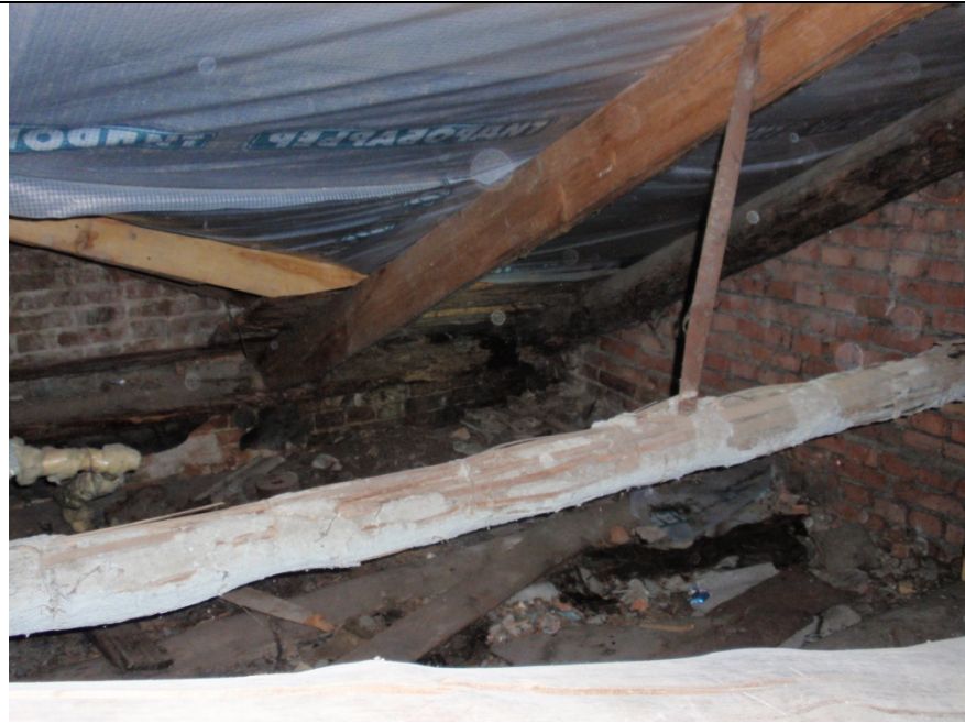
Загнивання мауерлату та крокв'яних конструкцій
