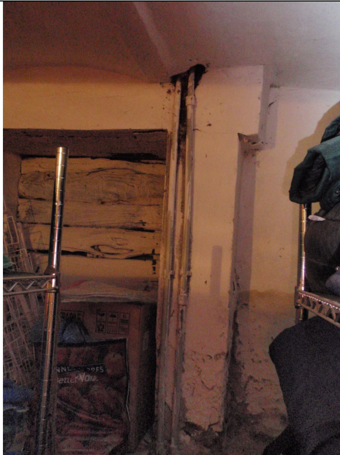
Руйнування несучих конструкцій
