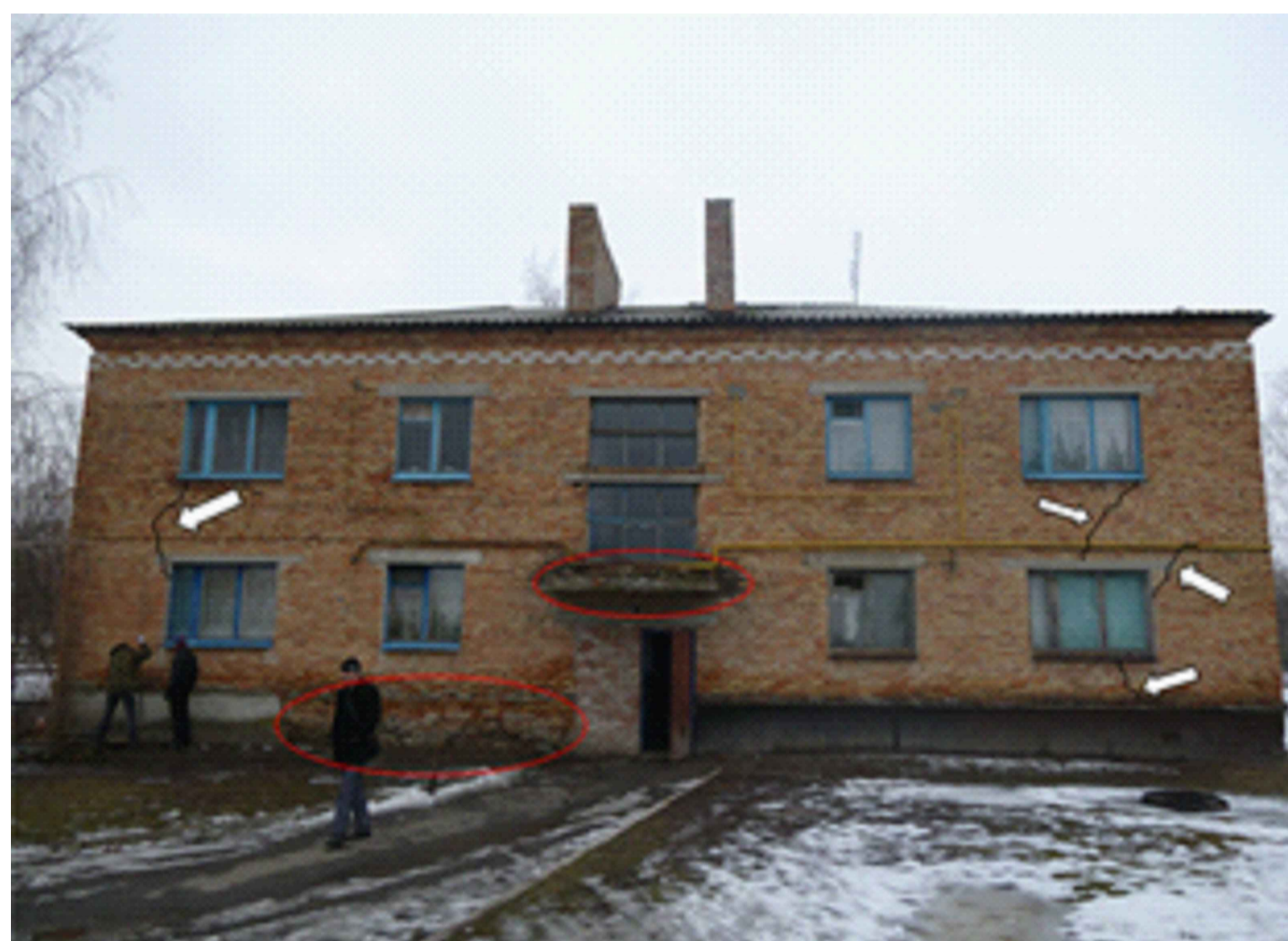
Замокання, грибок, ерозія, тріщини, морозобійне руйнування цегляної кладки та випадання швів між цеглою фасаду в осях 1-4
