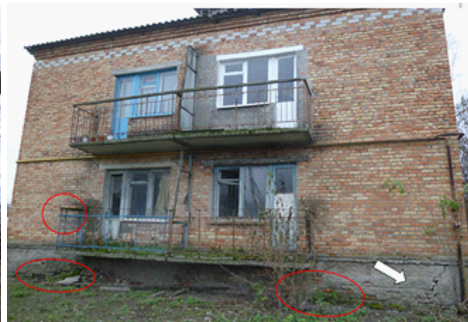
Замокання, грибок, ерозія, тріщини, морозобійне руйнування цегляної кладки та випадання швів між цеглою фасаду в осях 1-4
