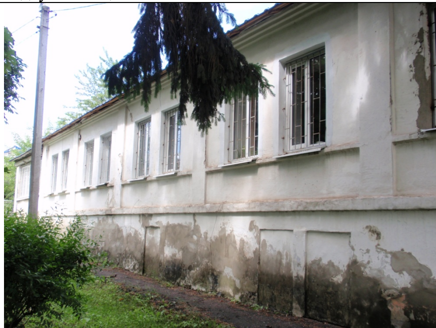
Руйнування цокольної частини будівлі
