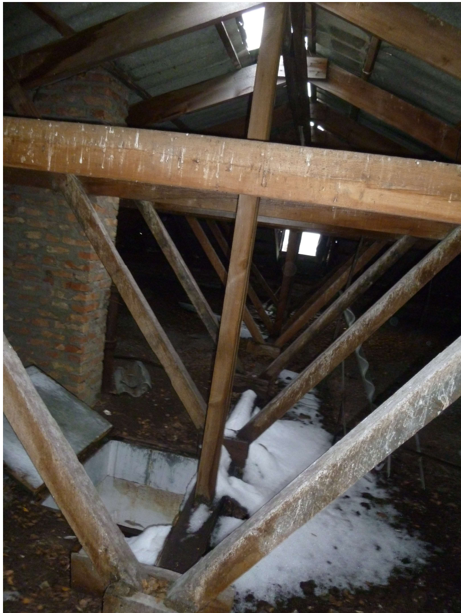
Рис. 3.1 – Відсутність гребеневого елемента на покрівлі
