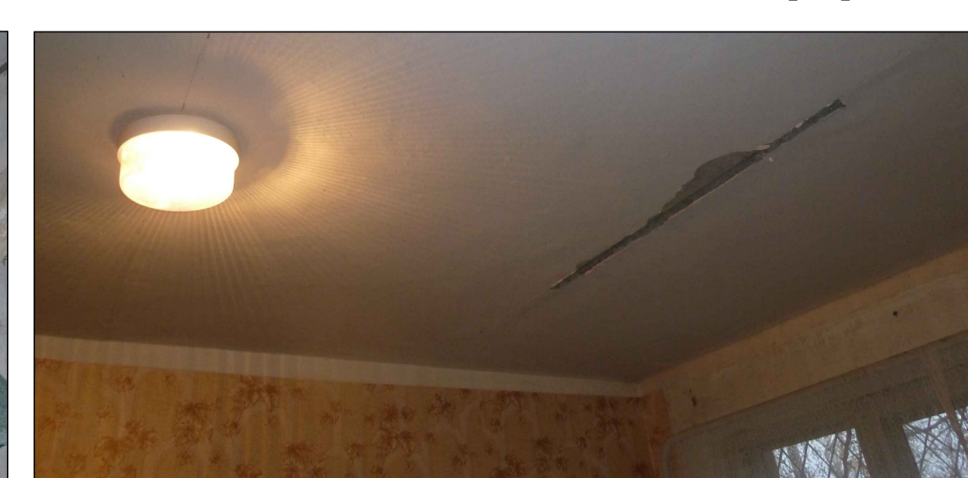
Випадання шва між з/б плитами перекриття
