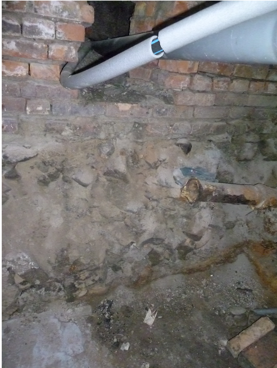
Рис. 3.12 – Порухення цілісності фундаменту будівлі ФАП
