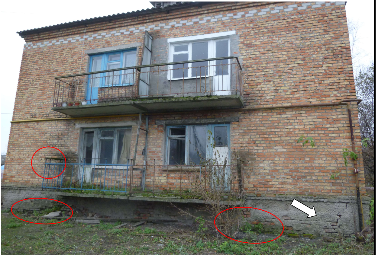
Рис. 3.9 – Замокання, грибок, ерозія, тріщини, морозобійне руйнування цегляної кладки та випадання швів між цеглою фасаду в осях 1-4.
