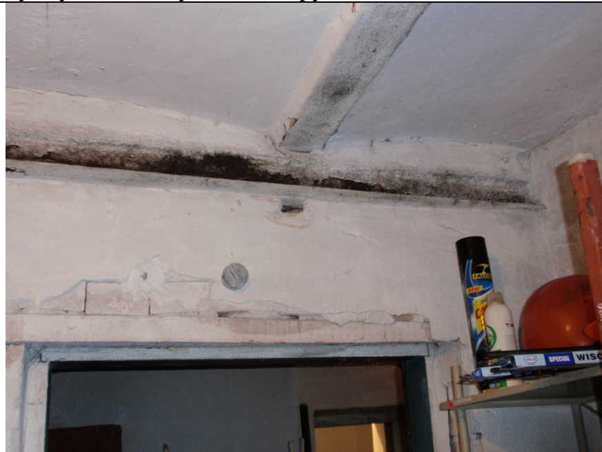
Корозійне пошкодження сталевих балок
