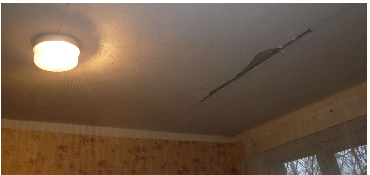
Рис. 3.10 – Випадання шва між з/б плитами перекриття
