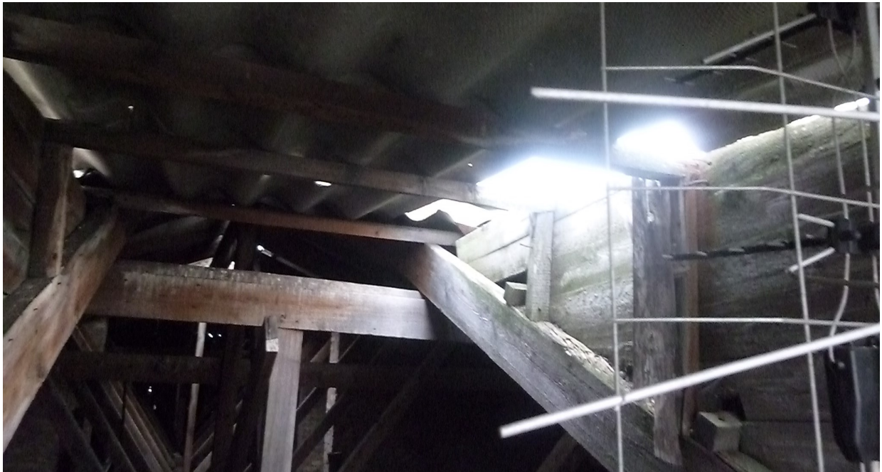
Рис. 3.2 – Наскрізні тріщини й надломи у азбестоцементних хвильових листах
