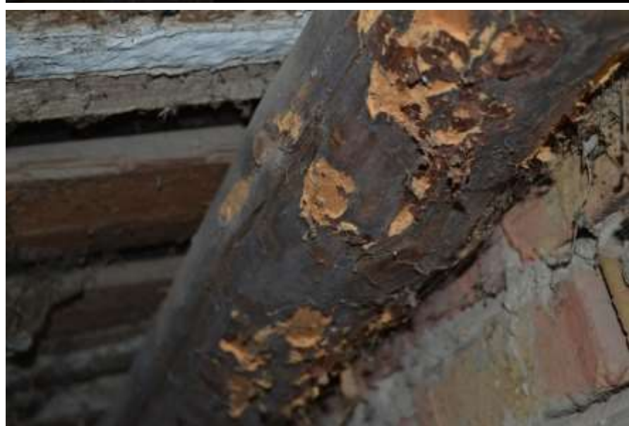
Ураження несучих дерев'яних конструкцій біошкідниками
