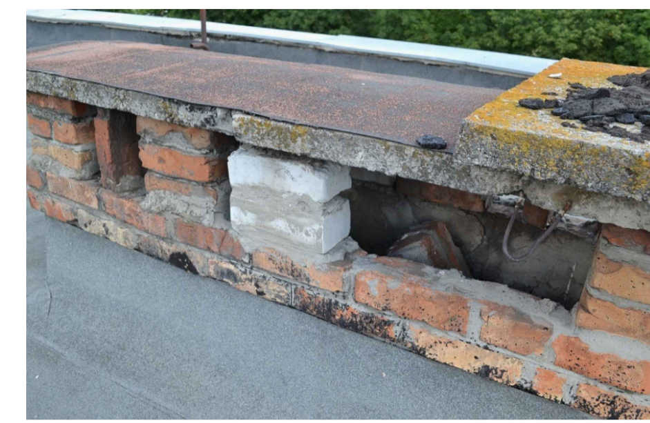
Руйнування цегляної вентиляційних каналів
