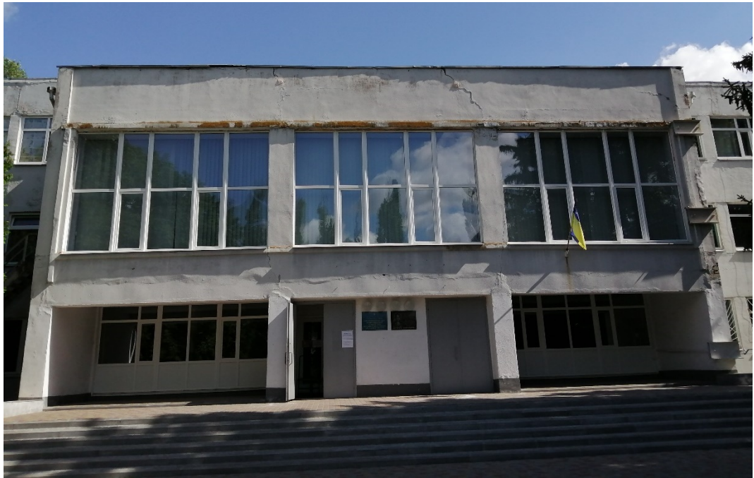
Рис. 3.23 – Тріщини на фасаді будівлі, що виникли внаслідок нерівномірних осідань основ фундаментів
