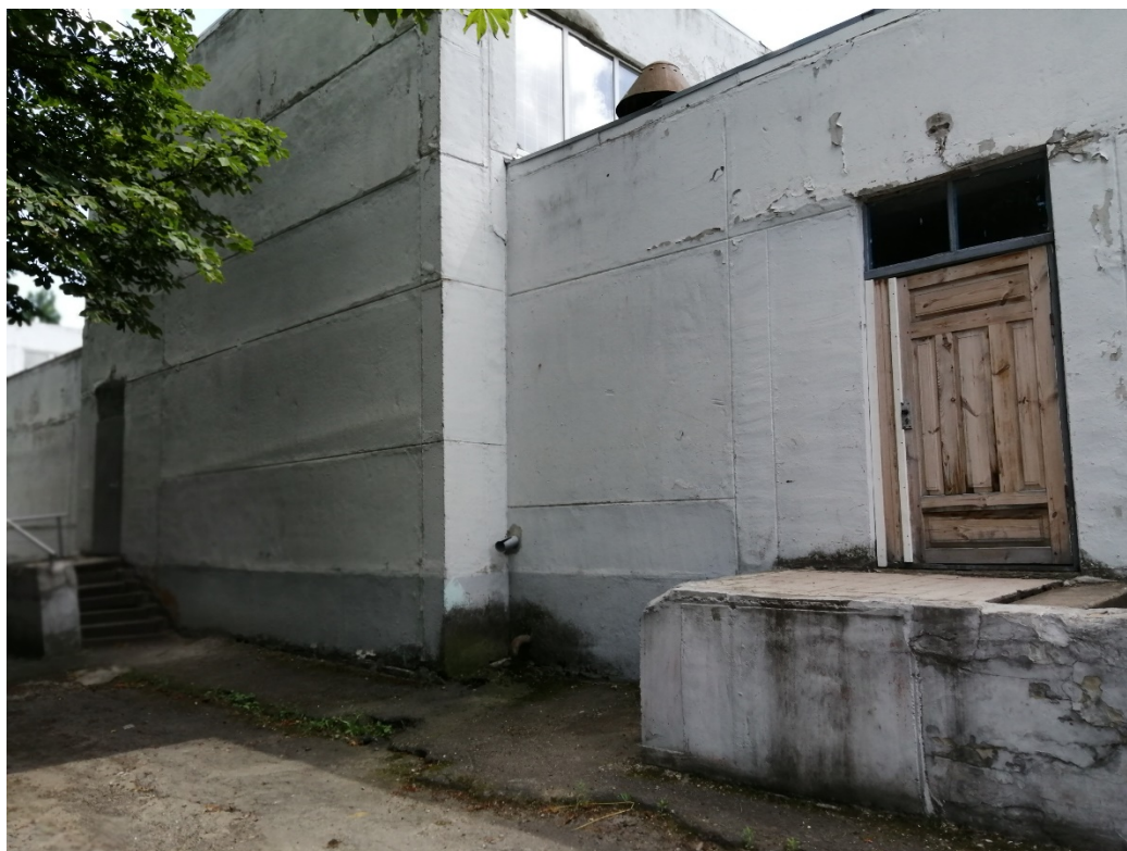
Рис. 3.19 – Пошкодження у вимощенні навколо будівлі
