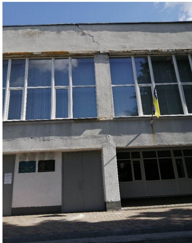
Рис. 3.24 – Тріщини на фасаді будівлі, що виникли внаслідок нерівномірних осідань основ фундаментів
