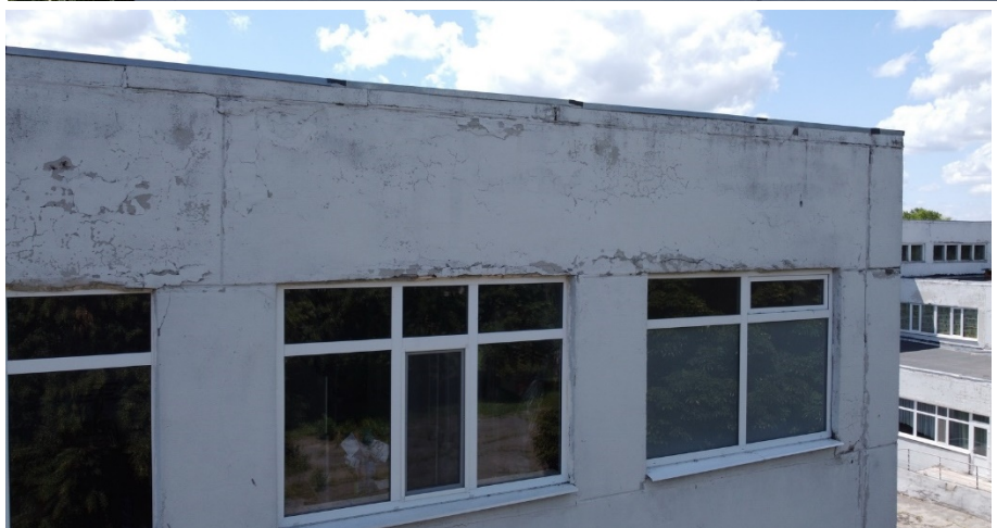
Руйнування оздоблювального шару та вивітрювання будівельного розчину між залізобетонними стіновими панелями
