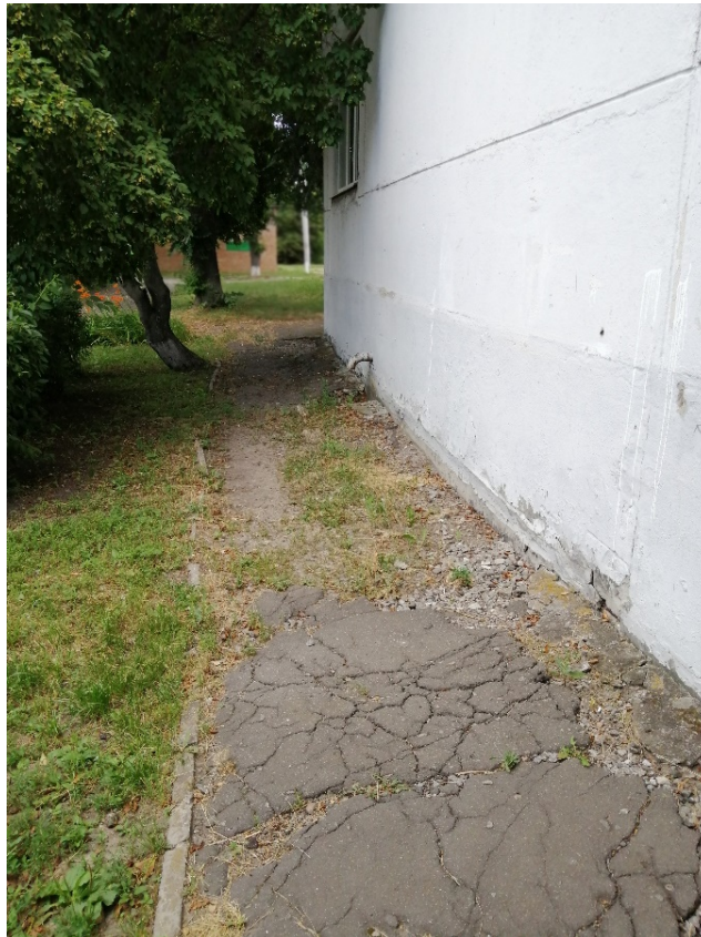
Рис. 3.17 – Пошкодження у вимощенні навколо будівлі
