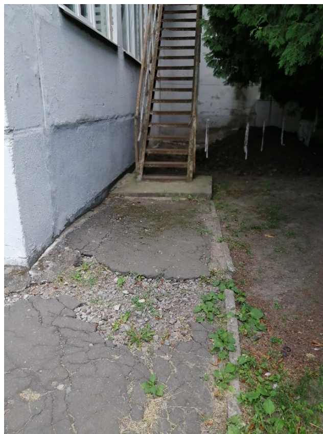
Рис. 3.18 – Пошкодження у вимощенні навколо будівлі
