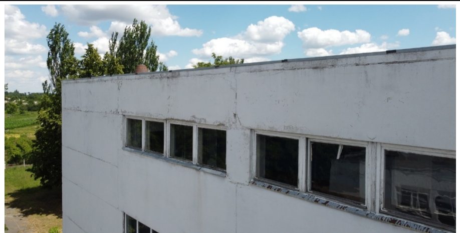
Руйнування оздоблювального шару та вивітрювання будівельного розчину між залізобетонними стіновими панелями
