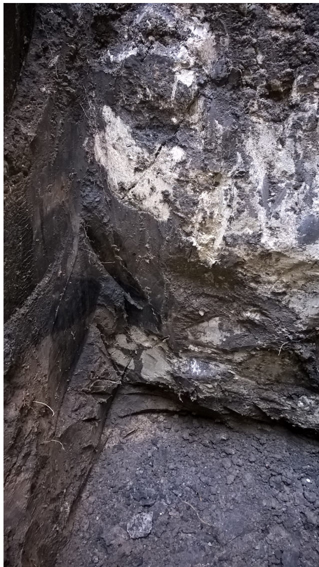
Рис. 4.2 – Шурф №4 у дворі будівлі (вісь 7), розширення під фундаментні блоки зі щебню та цементного розчину, тріщина в розширенні
