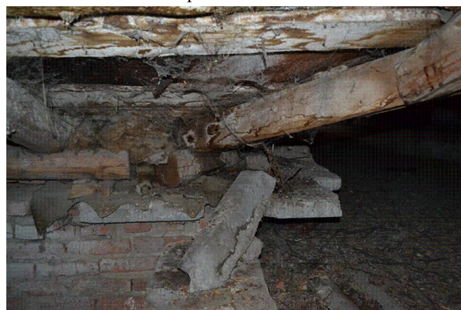
Замокання, як наслідок, загнивання елемента кровляної системи
