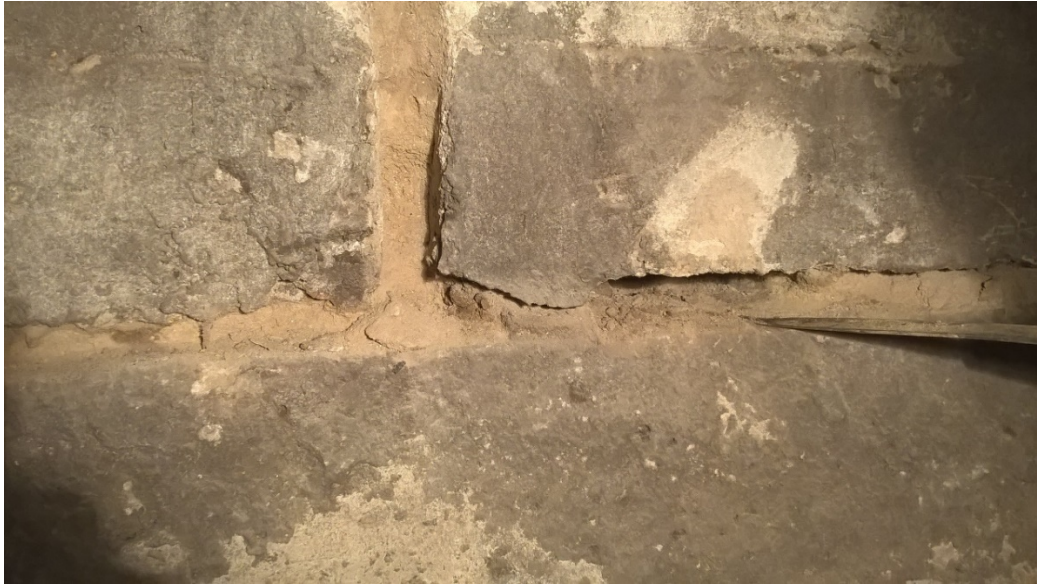
Рис. 4.4 – Вивітрілі шви між фундаментними блоками над шурфом №1 у підвалі будівлі (вісь 4)
