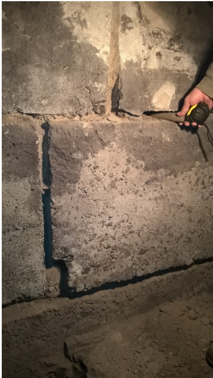
Рис. 4.3 – Вивітрілі шви між фундаментними блоками над шурфом №1 у підвалі будівлі (вісь 4)
