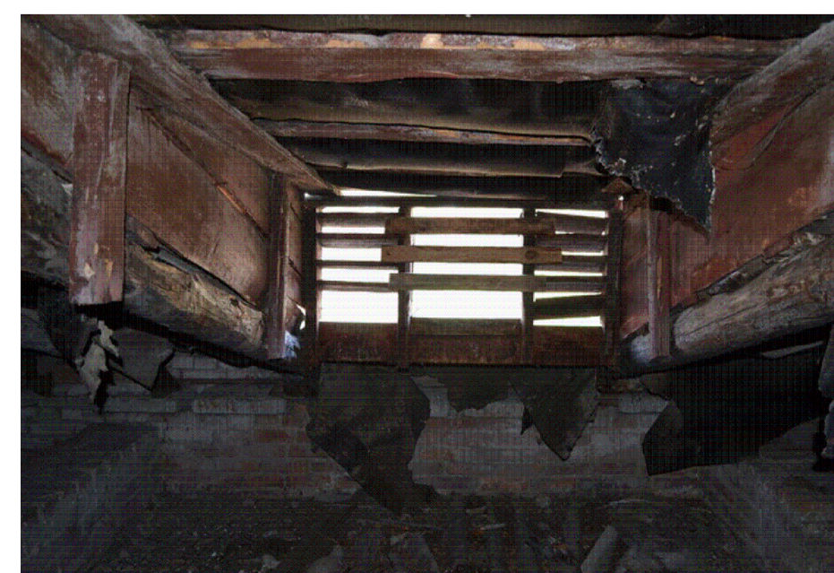
Руйнування конструкцій слухових вікон
