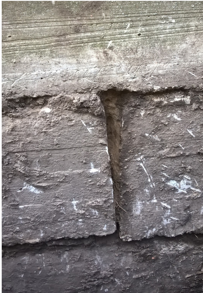
Рис. 4.5 – Вивітрілі шви між фундаментними блоками над шурфом №2 (вісь А)
