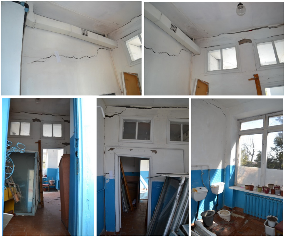
Просідання підлоги та тріщини по стінах
