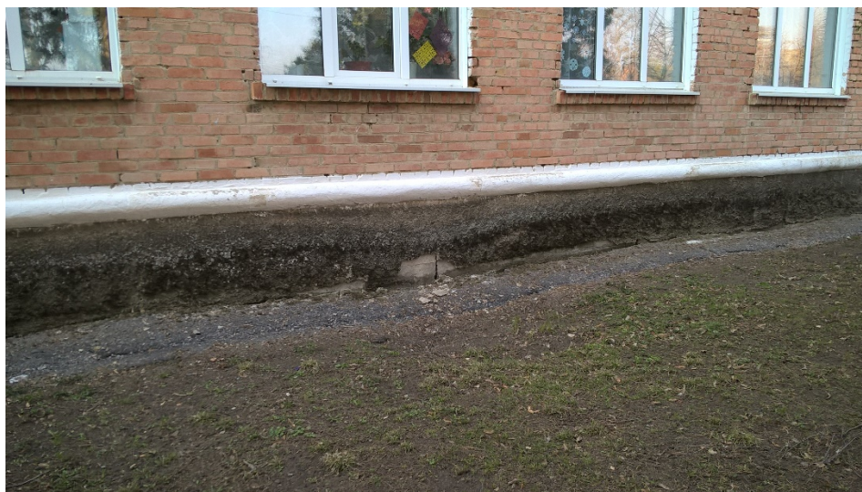
Рис. 4.18 – Прогини у вимощенні навколо будівлі (вісь А)
