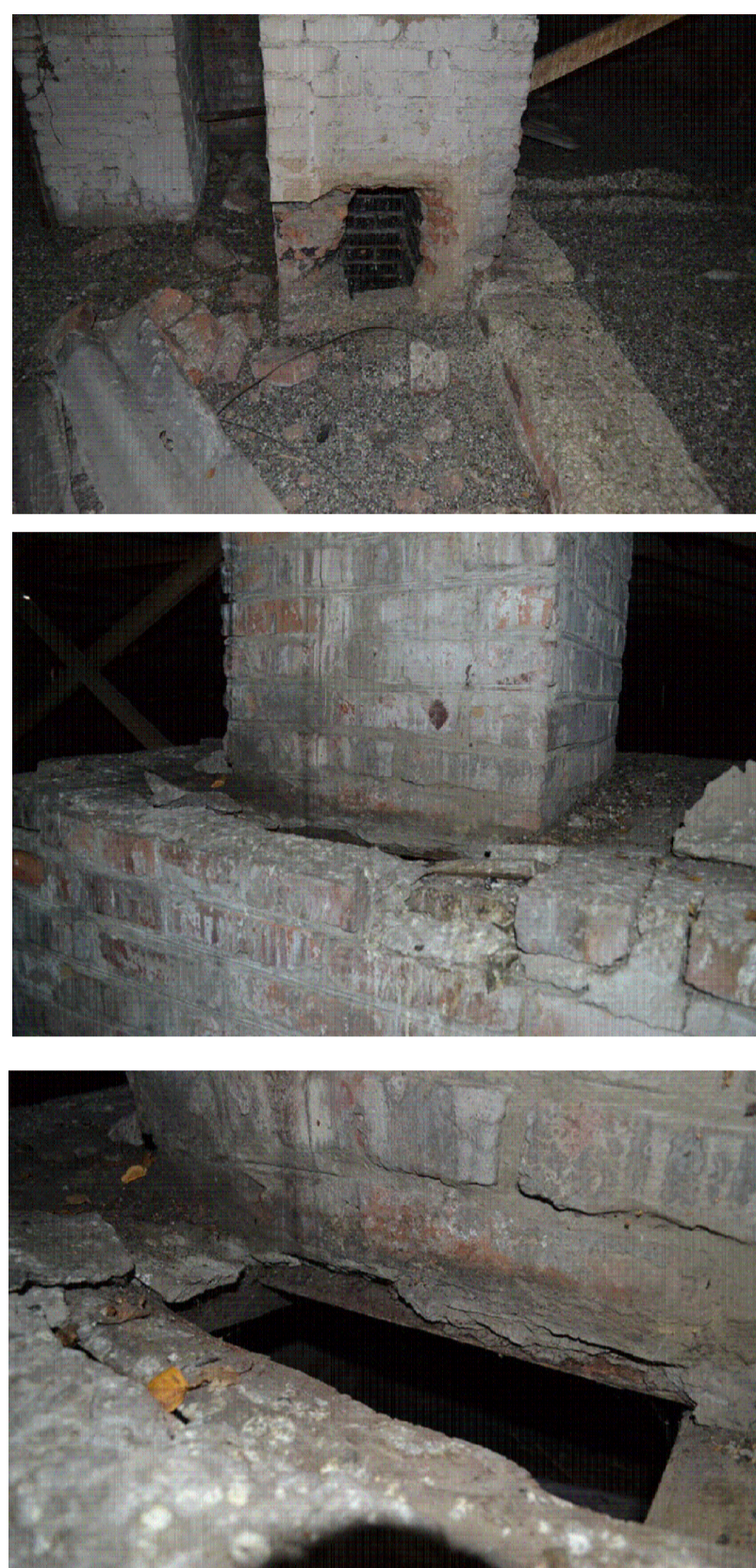
Руйнування вентиляційних каналів
