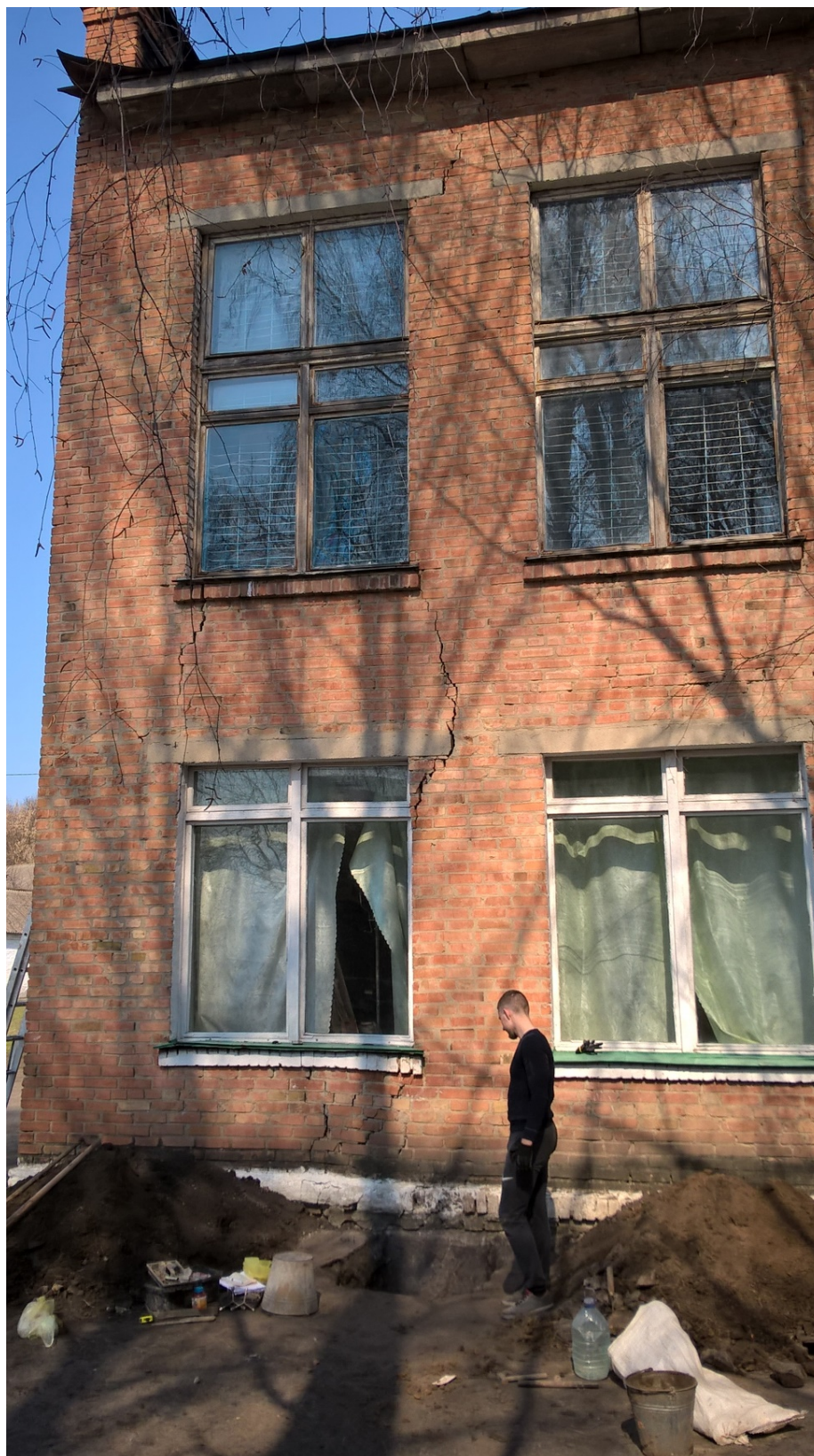
Рис. 4.16 – Шурф №4 у дворі будівлі (вісь 7), тріщини в несучій стіні будвлі над ним.
