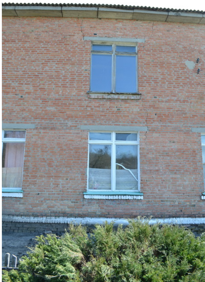
Тріщини по стінах будівлі шириною до 2 мм
