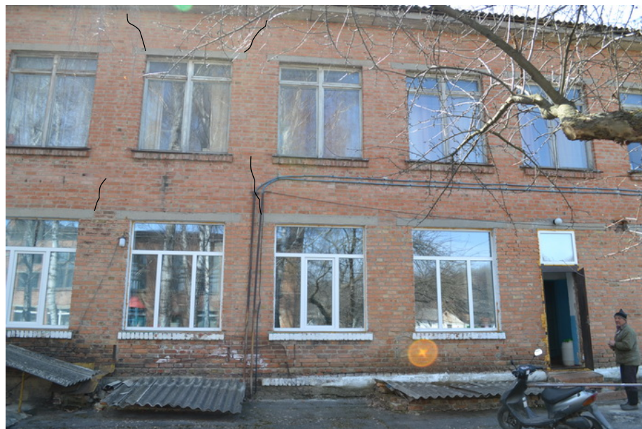
Тріщини по стінах будівлі шириною до 2 мм. Замокання стін.
