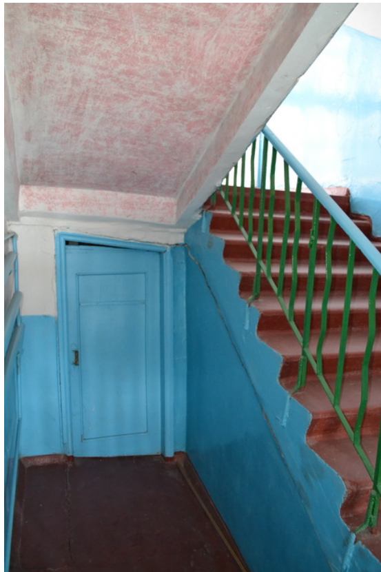
Просідання підлоги, порушення проектного положення сходиноквого маршу
