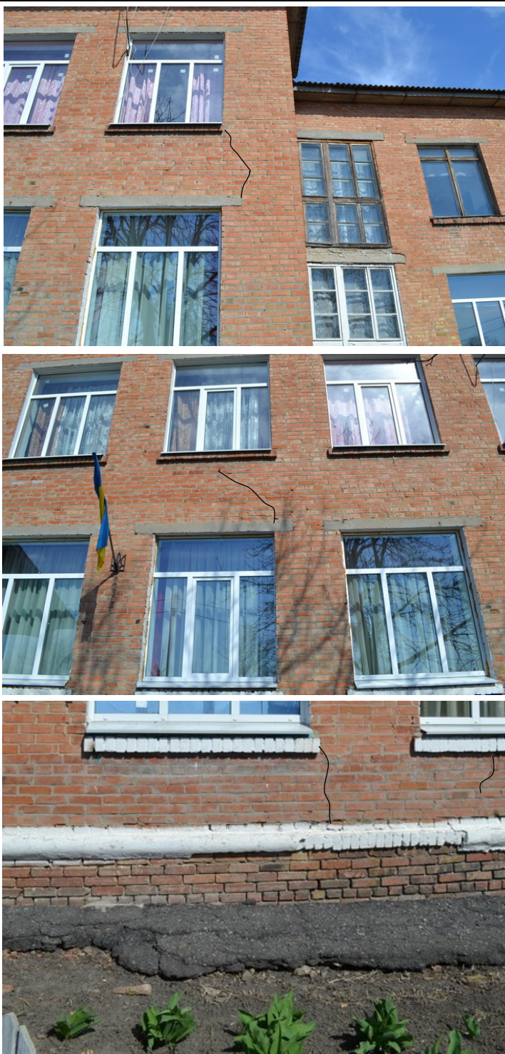
Тріщини по стінах шириною до 1 мм
