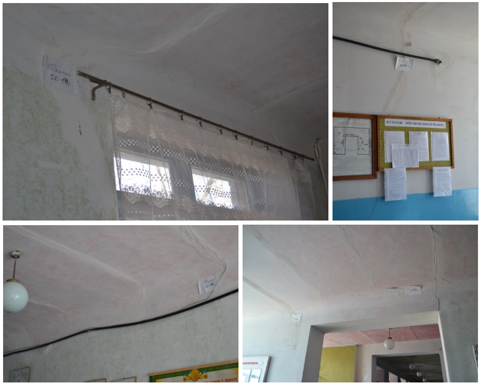
Тріщини у стінах та по сталі
