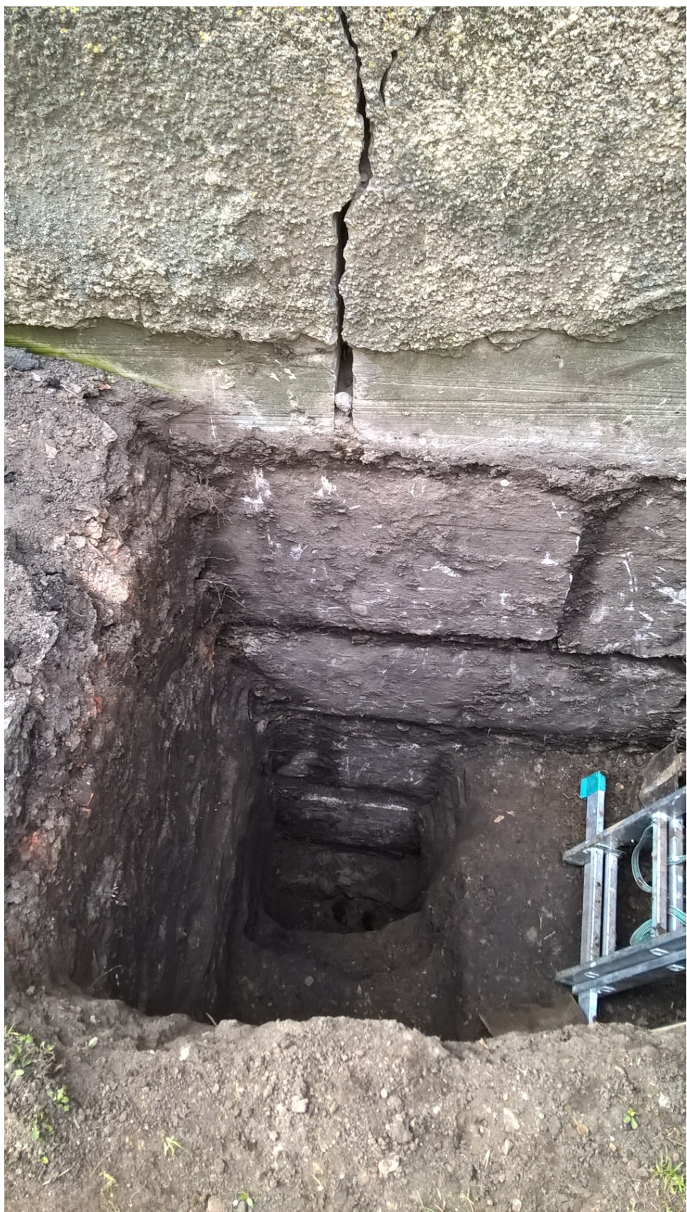
Рис. 4.6 – Шурф №2 (вісь А) і тріщина в цоколі будівлі ним
