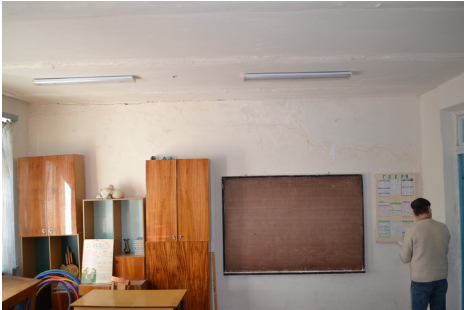
Нерівномірний прогин плит перекриття
