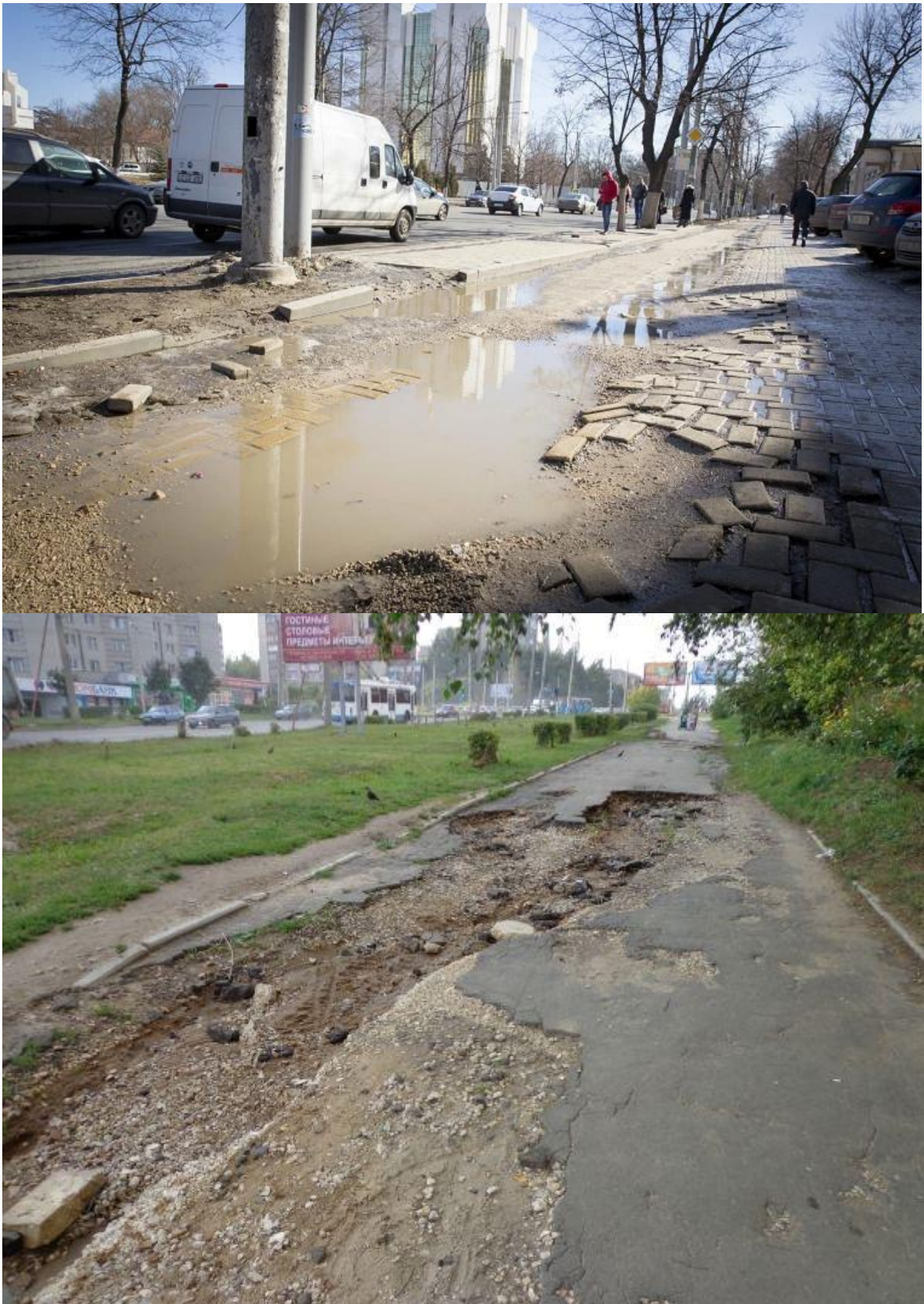
Рис. 1.12. Неналежний стан покриття пішохідного простору
