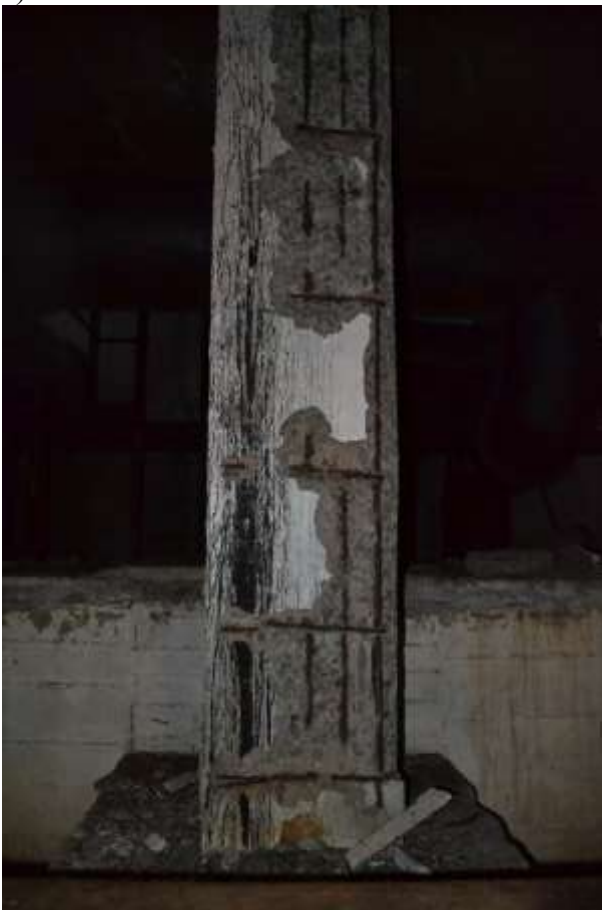
Рис. 1 – Пошкодження залізобетонних колон середнього ряду виробничої будівлі, що потребують підсилення
