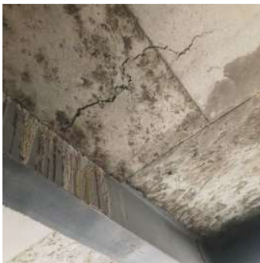
Рис. 1 – Пошкодження бетонної полицки сталезалізобетонного перекриття
