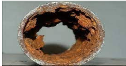
Рис.1. Прояви корозії на ділянках трубопроводу.
