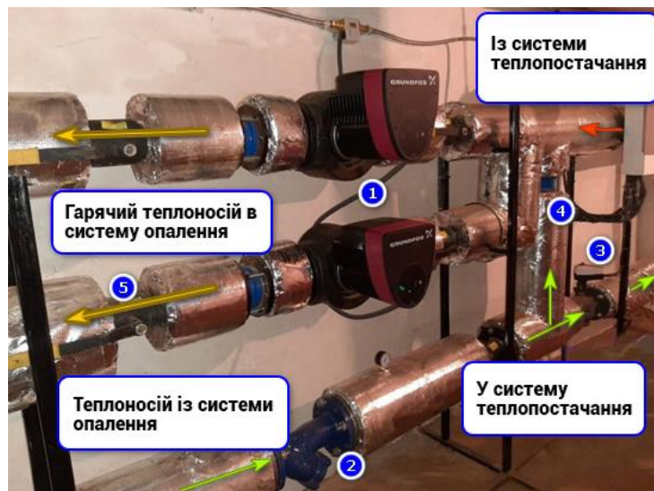
Рис. 2. Загальний вигляд автоматизованого ІТП у тепловому вузлі вводу будинку: 1 – циркуляційні насоси системи опалення; 2 – фільтр для теплоносія; 3 – регулятор витрат теплоти; 4 – байпас для подачі охолодженого теплоносія з системи опалення для розбавлення мережної води; 5 – запірні арматури
