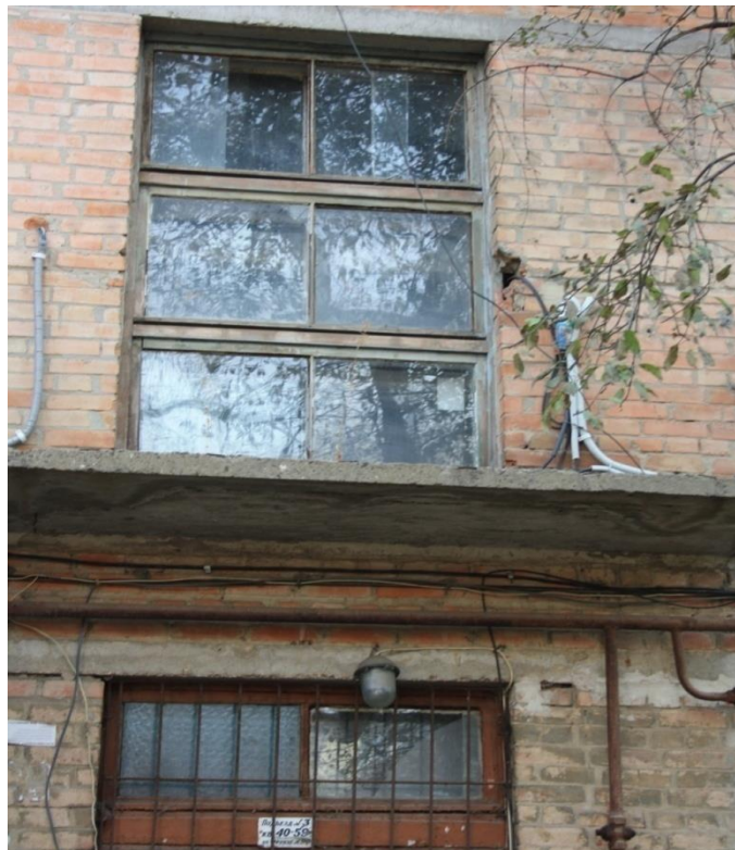
Рис. 6.7 – Введення телекомунікаційних мереж до 4 під'їзду житлового будинку по вул. Героїв АТО, 19.
