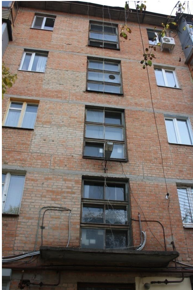
Рис. 6.5 – Стан скління сходових клітин будинку по вул. Героїв АТО, 19
