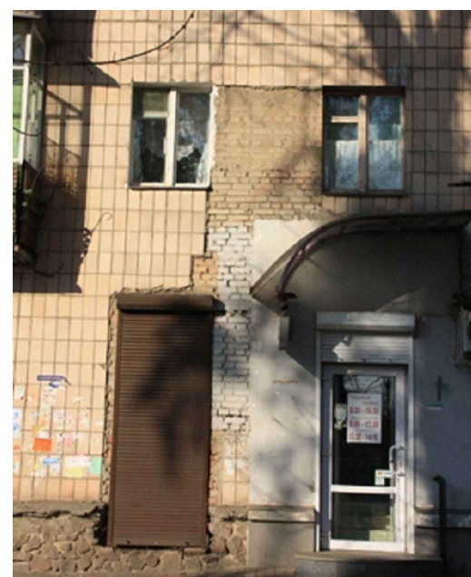
Елемент фасаду з пошкодженим зовнішнім облицюванням
