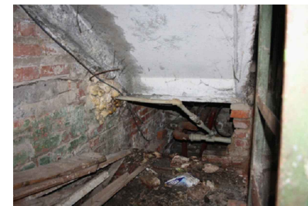
Підвальне приміщення з прокладеними розподільчими трубопроводами
