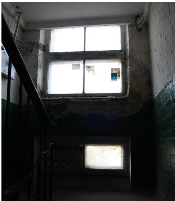
Рис. 6.6 Стан огороджувальних конструкцій неопалюваних під'їздів будинку.
