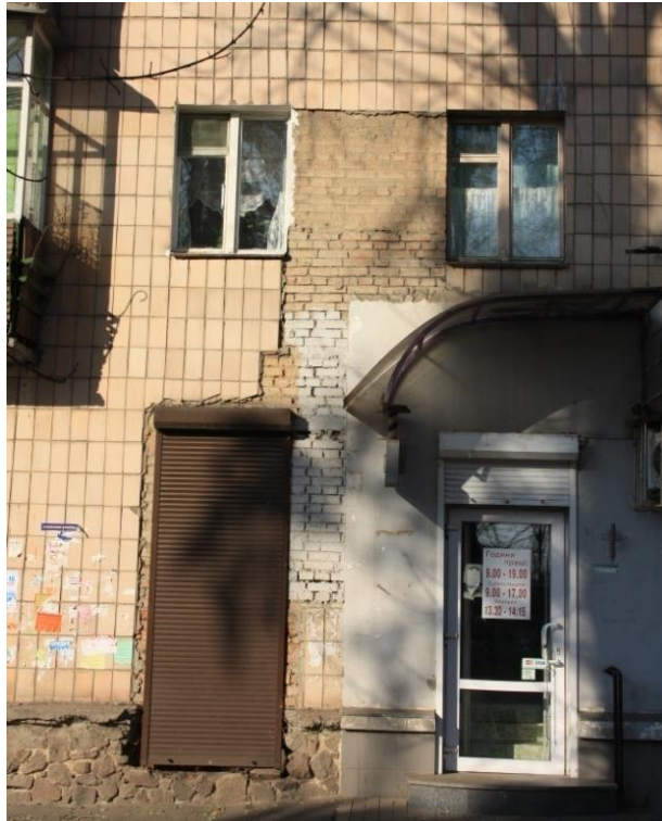
Рис. 6.4 – Елемент фасаду з пошкодженням зовнішнім облицюванням.
