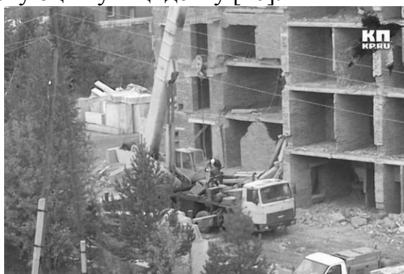
Рис. 4. Руйнування недобудованого житлового будинку, Урал, Росія, вересень 2016 року
