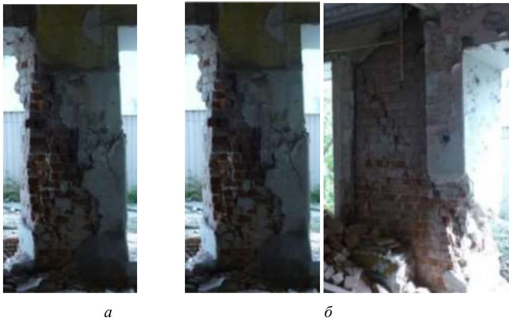
Рисунок 4.8 – Характер руйнування цегляних простінков: а – система вертикальних тріщин; б – похила тріщина
