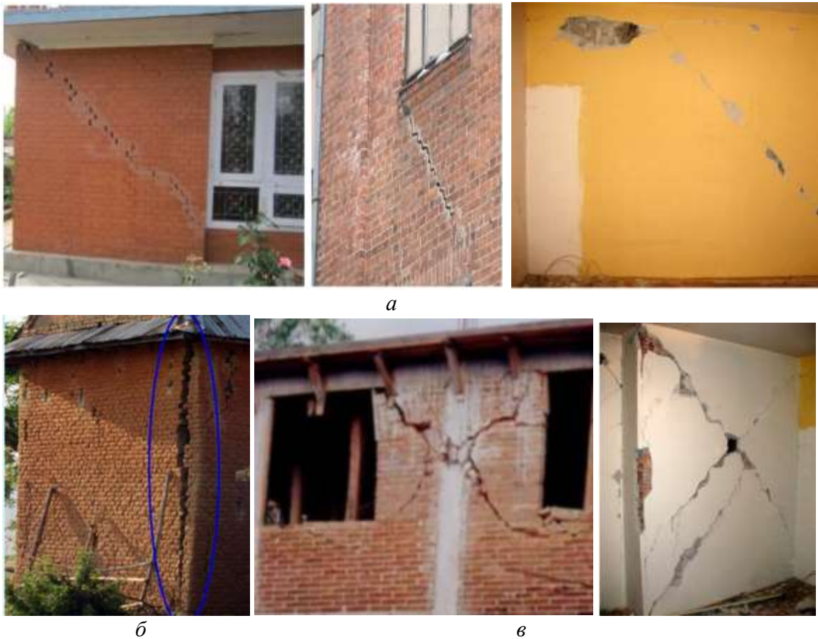
Рисунок 1.2 – Характер руйнування цегляних стін при сейсмічних впливах: а – діагональні тріщини; б – вертикальна тріщина в місці примикання поздовжніх і поперечних стін; в – хрестоподібна тріщина в простінку та глухій стіні
